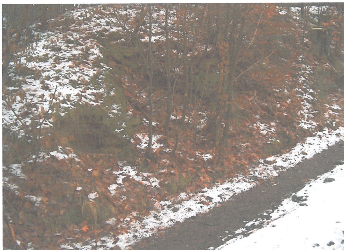
Foto 20. Skarpa po drugiej stronie drogi – niestabilna. Widoczne przemieszczenia.
