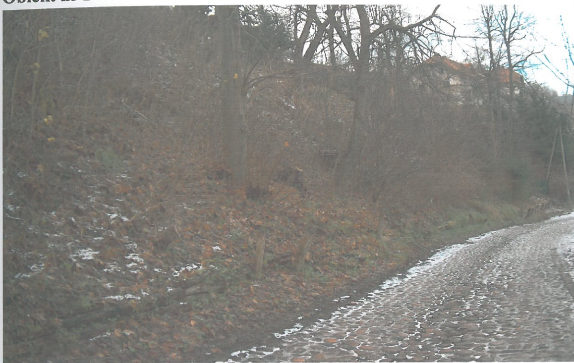
Foto 1. Widok na skarpe cz. A: zadrzewienia i krzewy umacniające skarpe. U podstawy widoczne stare drewniane umocnienia skarpy.
