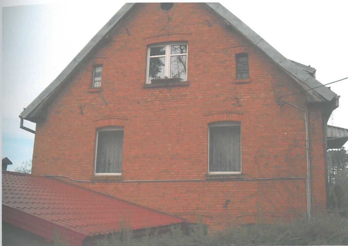
Foto 7. Budynek na skarpie. Liczne pęknięcia ściany szczytowej.
