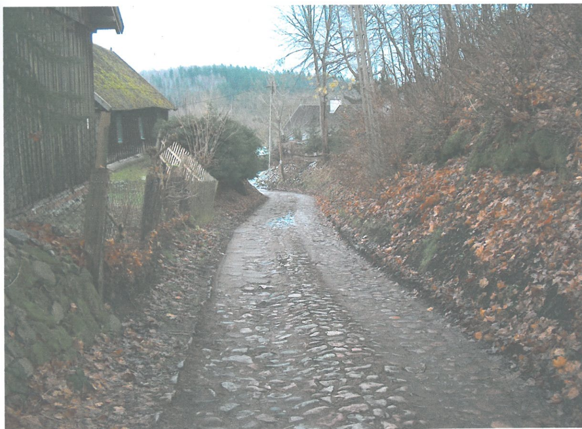
Foto 14. Widok na drogę gminną u podstawy skarp II. Istniejący słup linii napowietrznej pod wpływem naporu mas ziemnych odchyła się od pionu.
