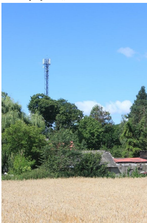
Fot. 14. Stacja bazowa telefonii komórkowej koło Klonówki
