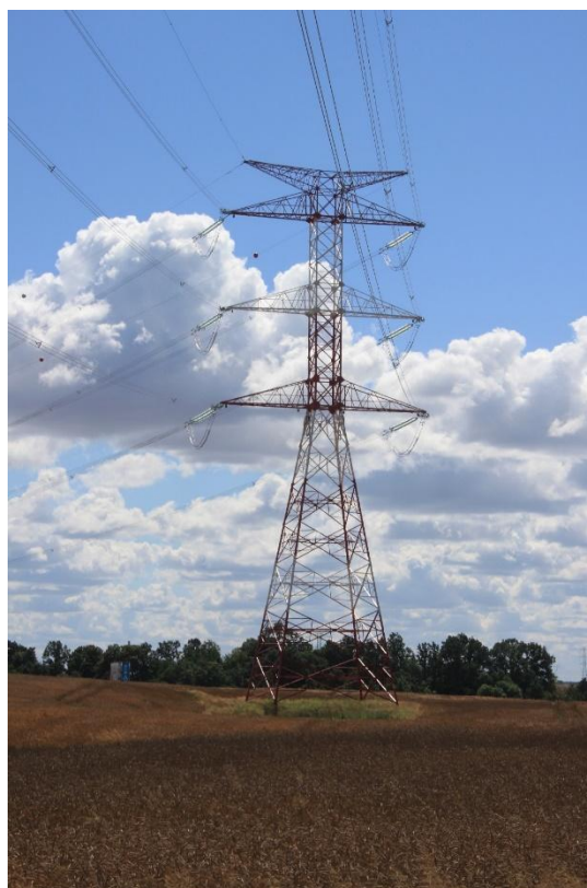
Fot. 16. Słup linii elektroenergetycznej 400 kV na południe od Klonówki
