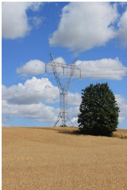
Fot. 15. Słup linii elektroenergetycznej 220 kV na wschód od Klonówki
