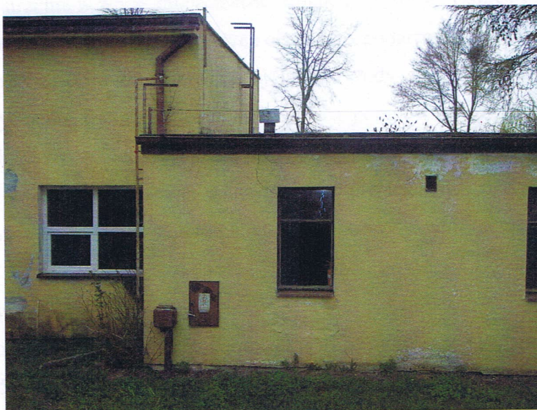
Pęknięcie ściany w rejonie nadproża i pod oknem do wzmocnienia klamrami
