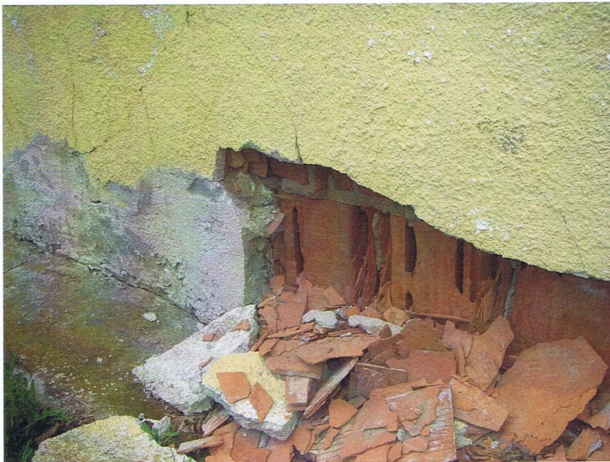
Zniszczona ścian pd.-wsch. w strefie przycokołowej do wzmocnienia
