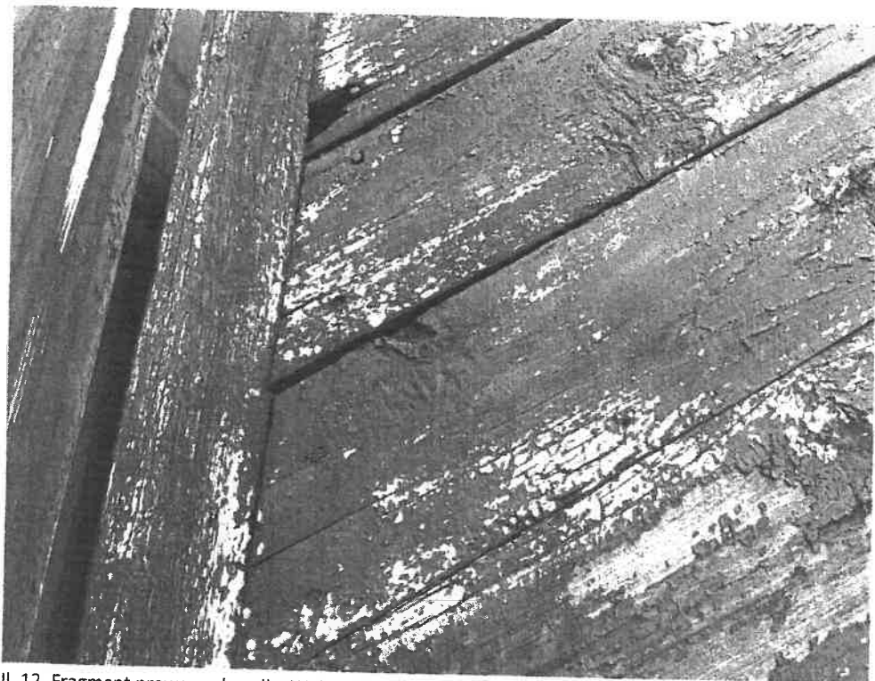
Il. 12. Fragment prawego skrzydła. Widoczne rozchodzące się szczeliny między deskami, spękana desek, ich ubytki i rozległe ubytki warstwy farby (fot. K. C-J).
