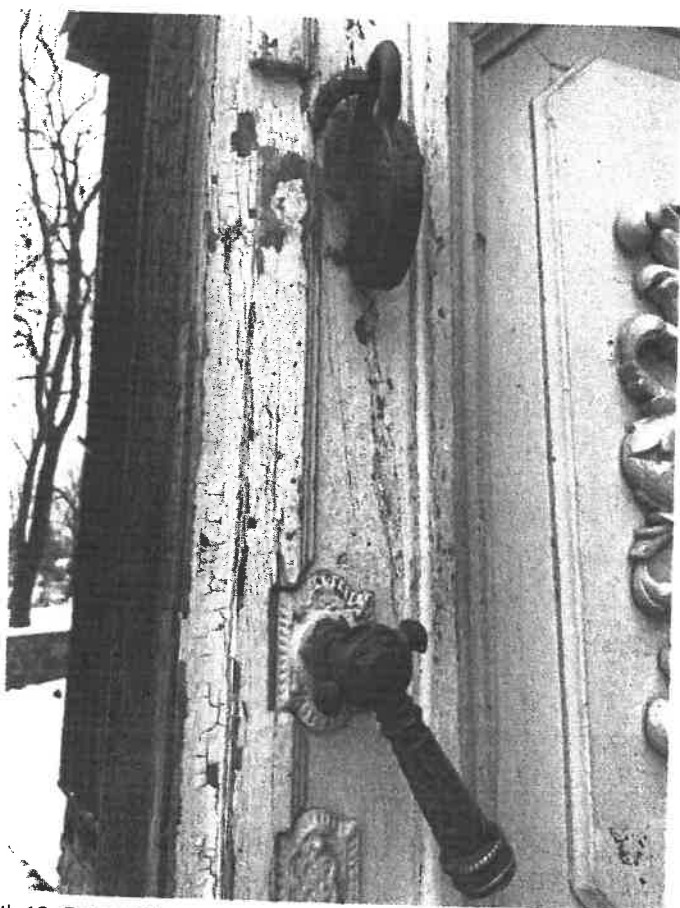
Il. 13. Fragment wewnętrznej strony skrzydła. Zły stan zachowania warstwy farby, pokrywającej również elementy metalowe (fot. K. C-J).
