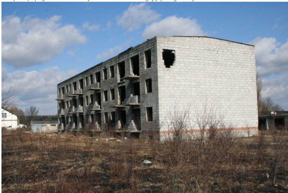
Rysunek 11 Budynek popegeerowski w miejscowości Zalesie ulegający degradacji.
