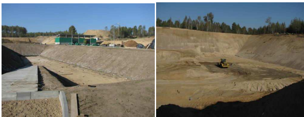
Kwatery odpadów azbestowych
