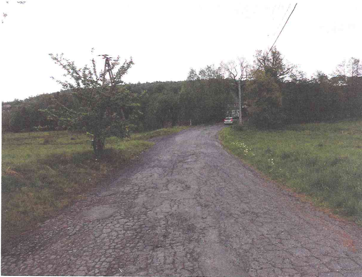
Widoczne spękania nawierzchni.
