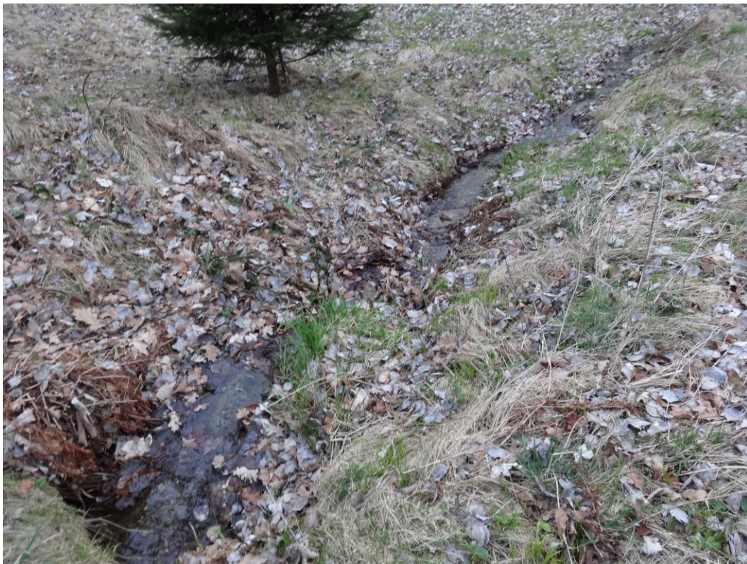
Wylot przepustu i rów w km 1+762( przepust do wymiany)
