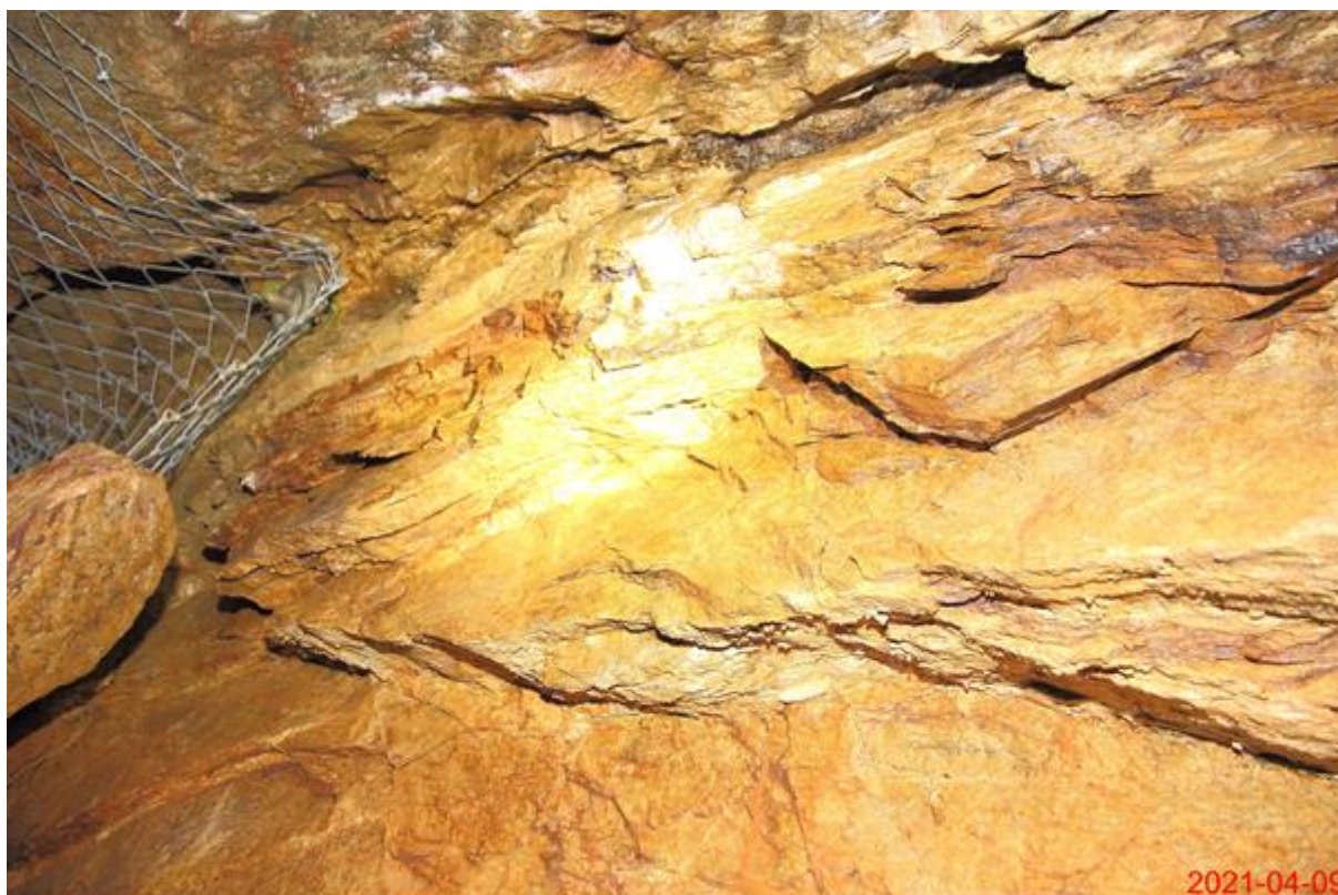
Fot. 7. Widok na północne naroże ociosu, przy stropie. Widoczny wiszący na siatce ochronnej fragment skalny
