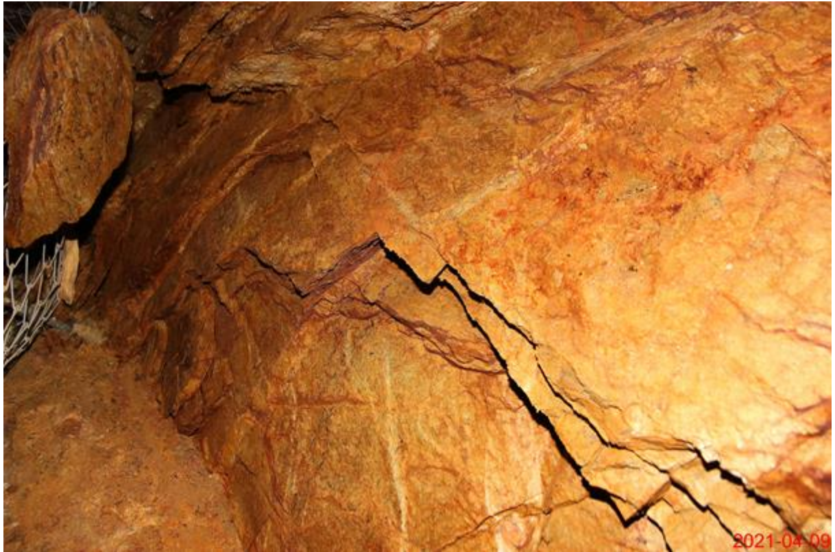
Fot. 10. Ocios południowy wiszący. Płaszczyzna odspojenia skał podczas obwał.
