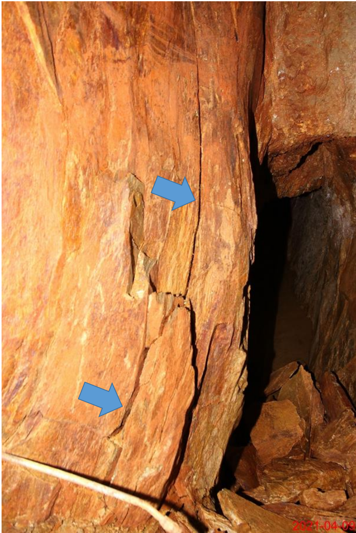
Fot. 9. Ocios południowy wiszący. Widoczne kolejne pęknięcia o szerokości dochodzącej do 2,5 cm
