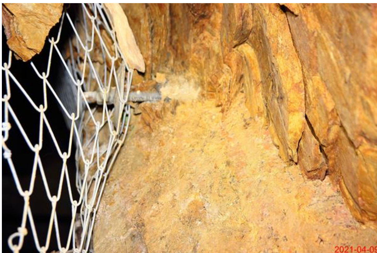
Fot. 8. Ocios południowy wiszący. Kotwa w ostatnim zabudowanym rzędzie wskutek obwału uległa niewielkiemu odsłonięciu
