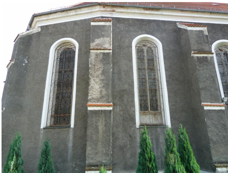
Fot.8. fragment fasady północnej- ubytki tynku na przyporach
