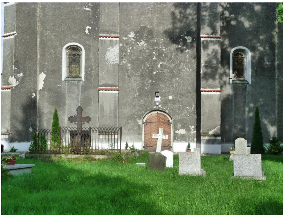
Fot.7. fragment elewacji zachodniej-widoczne liczne ubytki tynku.
