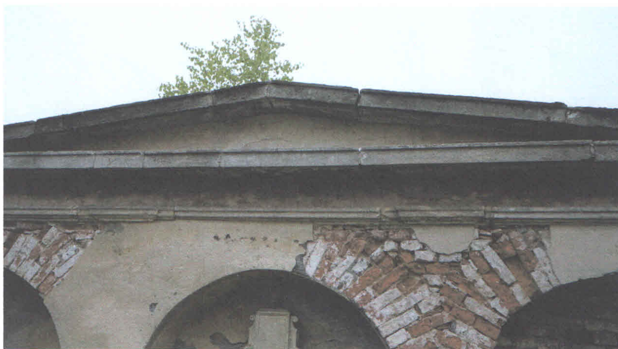
Fot,27, Stan zachowania obiektu przed konserwacją. 2018r.
