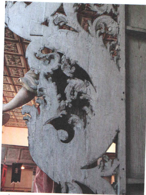
- odwrócić uszaków – widoczna działalność czynnych drewnojadów
