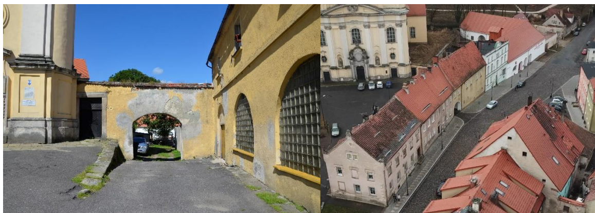
mur w złym stanie technicznym
