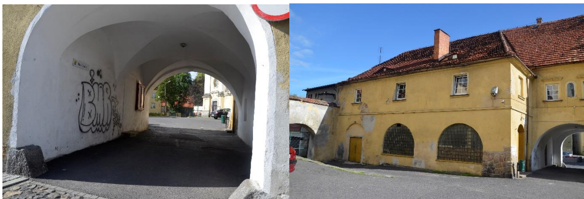
nieuporządkowana nawierzchnia asfaltowa w sklepionym przejeździe oraz od strony południowej obiektu
