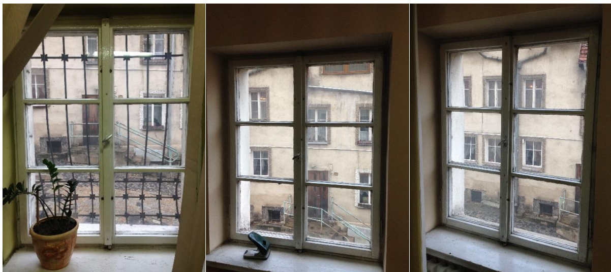
Okna przeznaczone do wymiany na okna drewniane o takim samym kształcie i podziałach.
