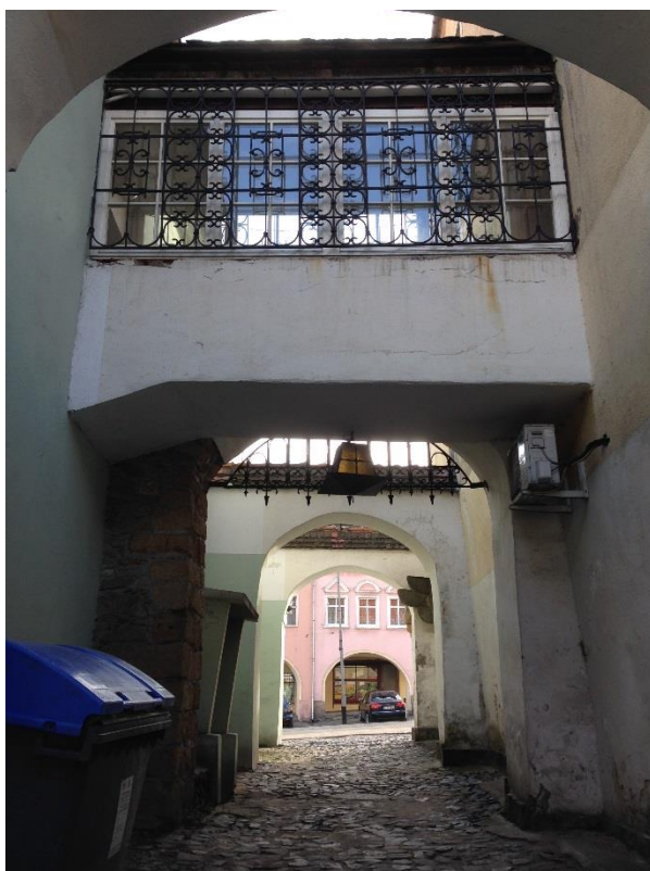
Widok na budynek przeznaczony do remontu-łącznik i łuki na których trzeba wymienić tynki i pokrycie dachowe
