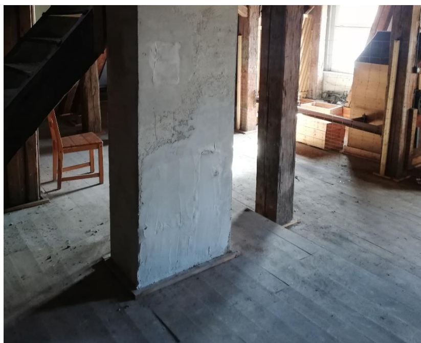
Niedocieplony strop budynku „D” – część przy wejściu na wieżę Ratusza
