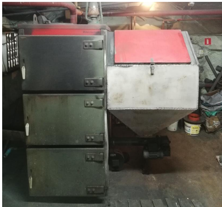
Kocioł w pomieszczeniu 0.42
