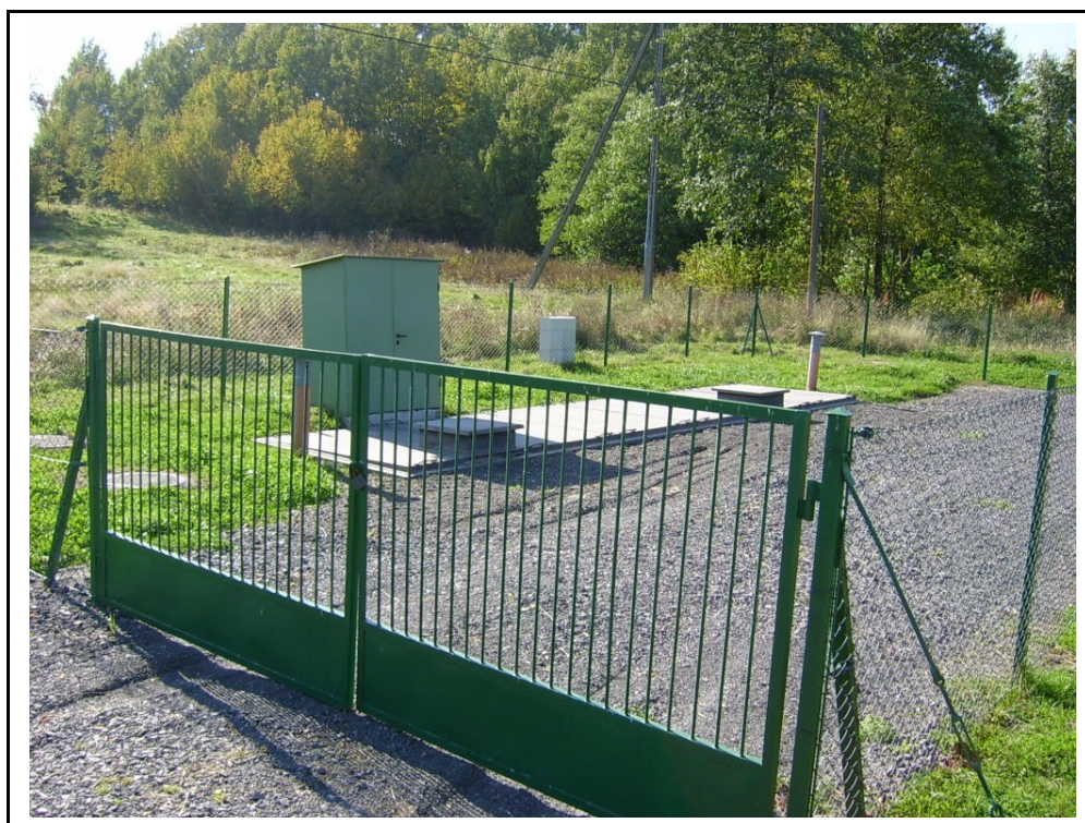
Rys. 2.4. Oczyszczalnia ścieków komunalnych w Janicach
