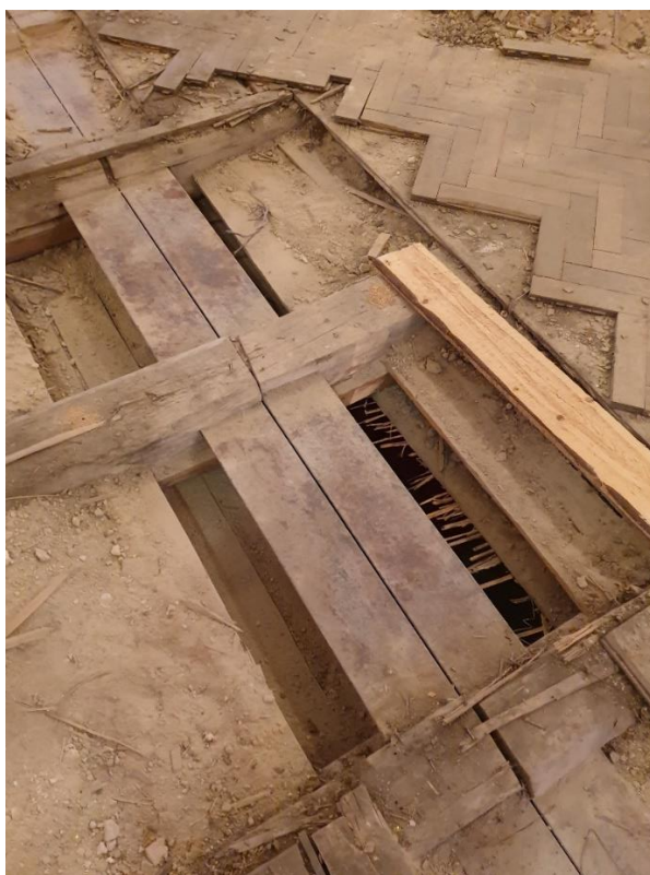
miejsce uszkodzenia stropu
