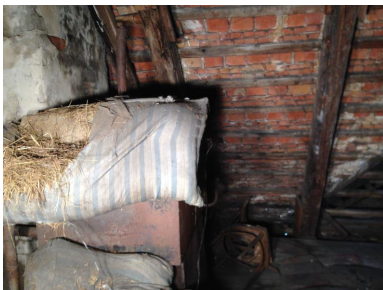
Fot. 16F. Brak obróbek komina, tynk na kominie zagrzybiony i odparzony, luźno odchodzi. Więźba w obrębie komina mocno zawilgocona, do wymiany.
