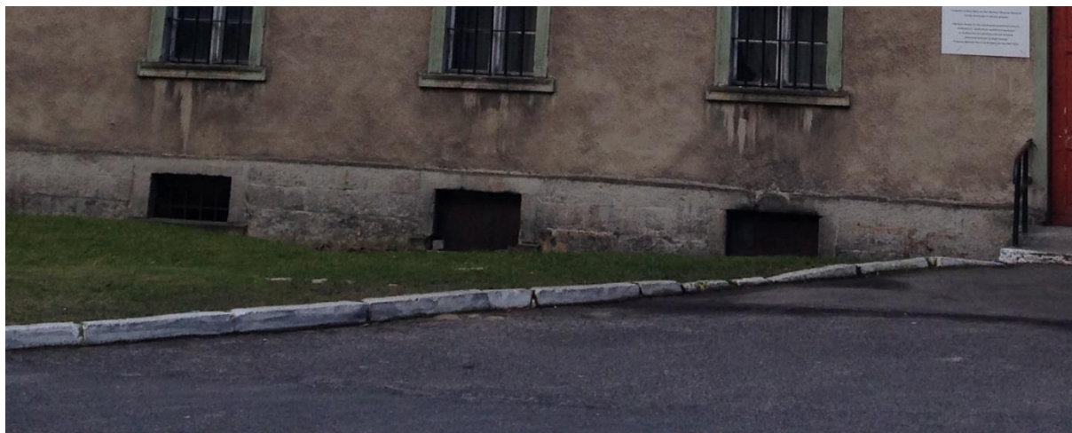
Powierzchnie kamienne wymagające odrestaurowania
