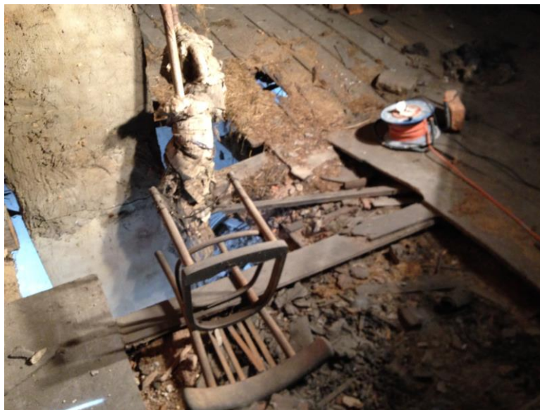
Fot. 19F. Przecięta jętka podczas murowania komina, brak wymianów. Strop strychu w tym obrębie w stanie awaryjnym, do pilnego remontu.
