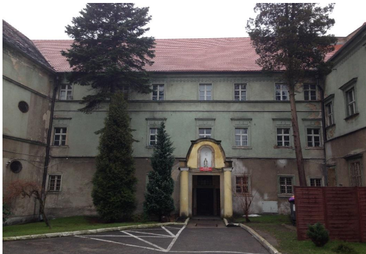
BUDYNEK „A”-do remontu tynki, sztukaterie, stolarka do wymiany, wymiana rur spustowych, remont wnętrz oraz instalacji wewnętrznej
