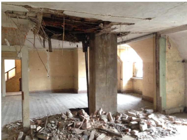
Fot. 4F. Komin wykonany wtórnie niezgodnie ze sztuką budowlaną, fragmenty stropu w stanie awaryjnym
