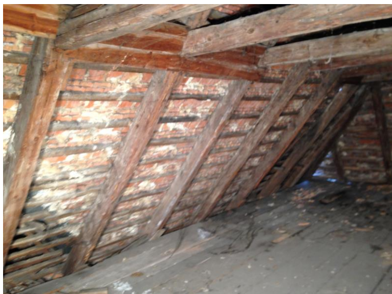
Fot. 15F. Widoczne naroże dachu ze śladami po licznych zalaniach. Więźba zawilgocona, częściowo zagrzybiona.
