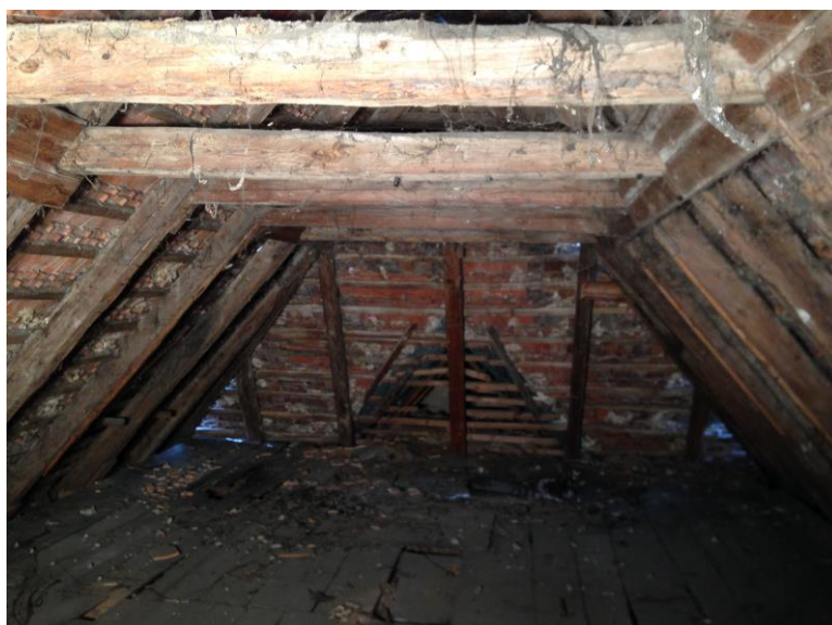
Fot. 14F. Ubutki w pokryciu dachowym skutkujące ciągłym zalewaniem naroży dachu.
