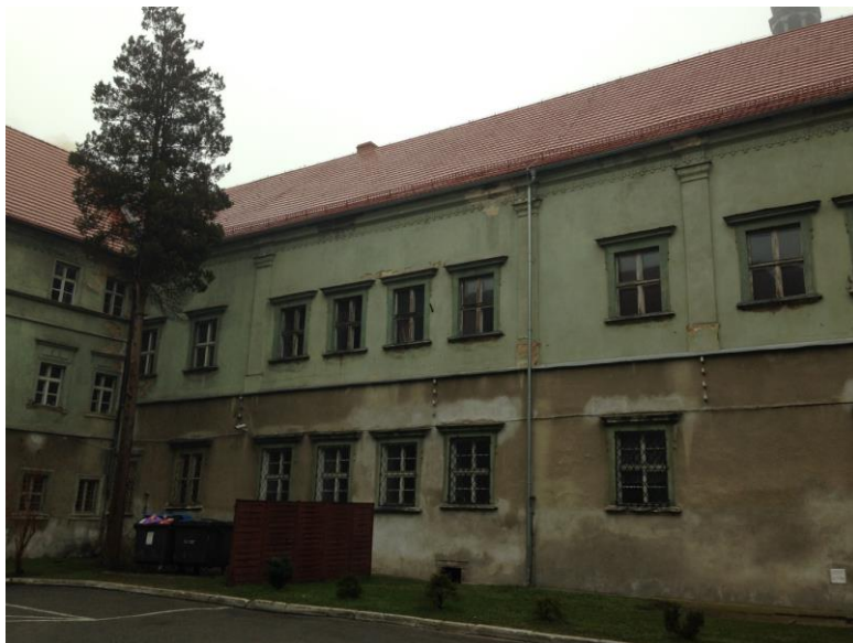
BUDYNEK „C”-do remontu tynki, sztukaterie, stolarka do wymiany, wymiana rur spustowych, remont wnętrz oraz instalacji wewnętrznej
