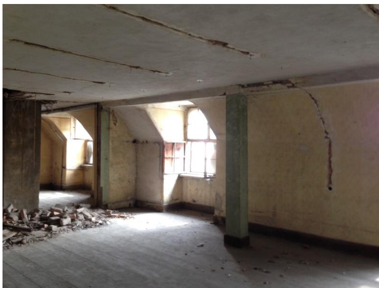
Fot. 5F. Ściana stolcowa, widoczny komin wykonany wtórnie niezgodnie ze sztuką budowlaną.
