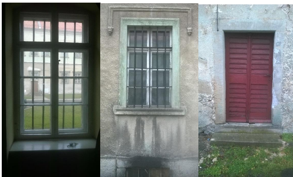
Przykładowe okna przeznaczone do wymiany na okna drewniane o takim samym kształcie i podziałach.
