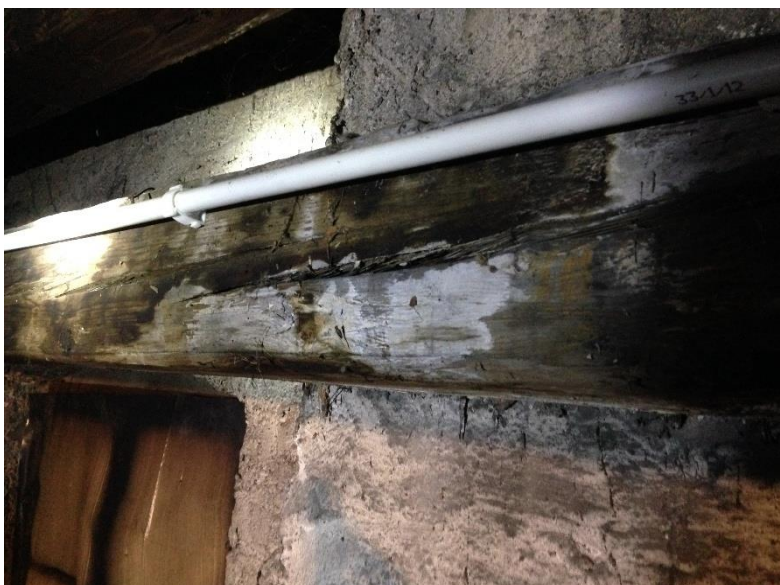
Fot. 10B. Częściowo zawilgocona i zagrzybiona jętka przy kominie.
