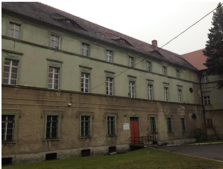
Budynek "B"- do remontu tynki, sztukaterie, stolarka do wymiany, pokrycie dachowe do wymiany, wymiana rur spustowych, rynien, remont instalacji odgromowej, remont wnętrz oraz instalacji wewnętrznej
