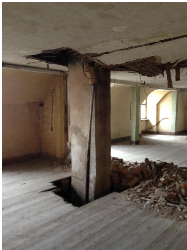
Fot. 6F. Widok na wykonany wtórnie komin oraz stropy będące w stanie awaryjnym.
