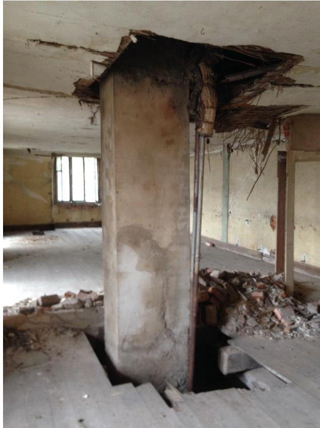
Fot. 7F. Widok na wykonany wtórnie komin oraz stropy będące w stanie awaryjnym.
