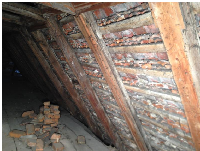
Fot. 17F. Krokwie porażone owadami, miejscami spróchniałe.
