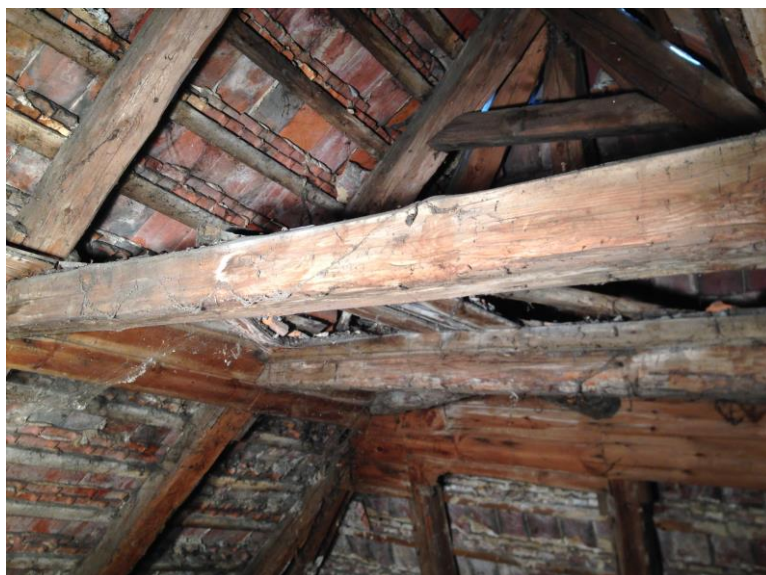
Fot. 12F. Zawilgocenie krokwi narożnych i kulawek.
