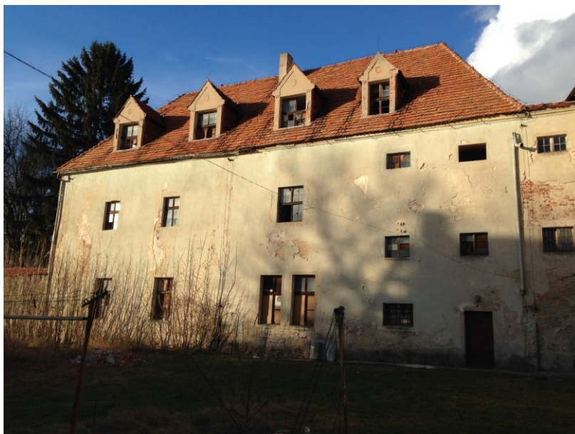
Budynek "G"- do remontu tynki, sztukaterie, stolarka do wymiany, pokrycie dachowe do wymiany, wymiana rur spustowych, rynien, remont instalacji odgromowej, remont wnętrza oraz instalacji wewnętrznej według dokumentacji technicznej
