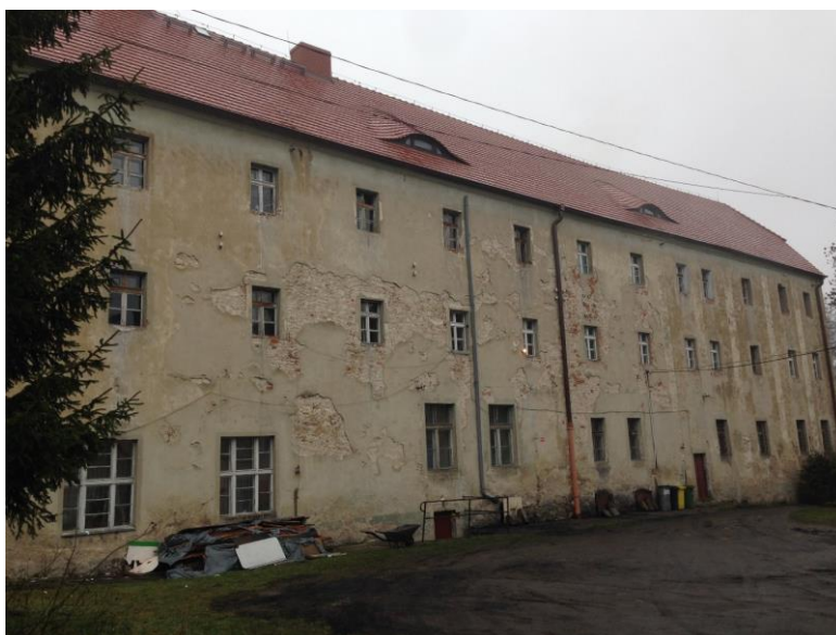
BUDYNEK „E”-do remontu tynki, sztukaterie, stolarka do wymiany, wymiana rur spustowych, remont wnętrz oraz instalacji wewnętrznej
