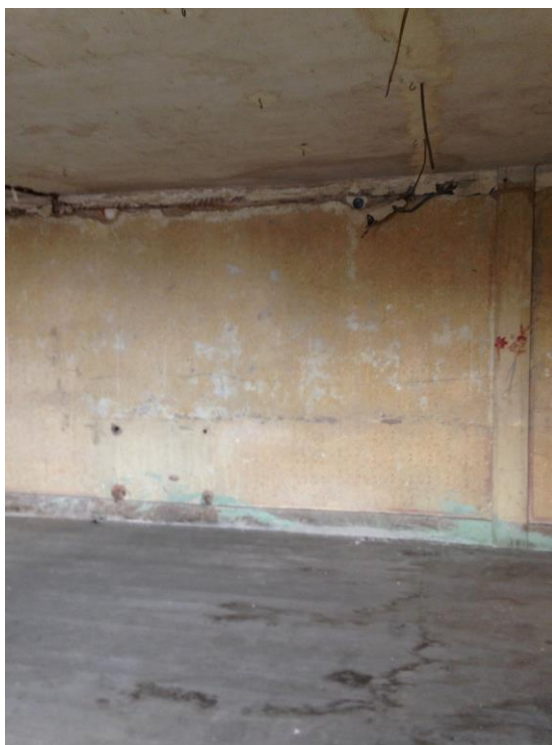
Fot. 2F. Ściana stolcowa poddasza, widoczne liczne zacieki posadzki
