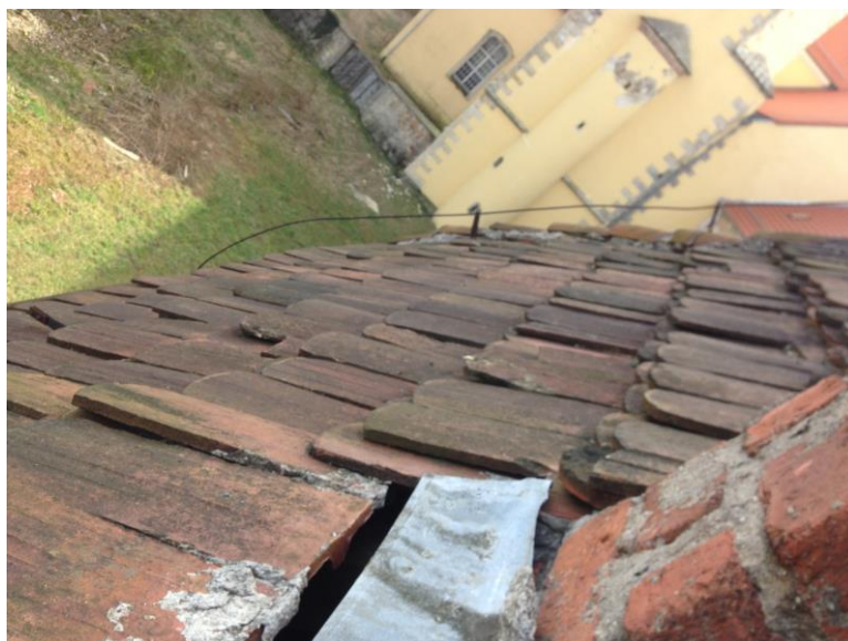
Fot. 11F. Błędnie wykonana obróbka komina. Pozostawiona dziura, przez którą dostaje się woda do budynku.
