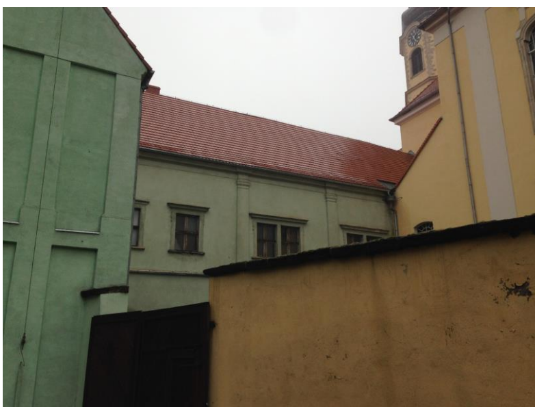
BUDYNEK „D”-do remontu tynki, sztukaterie, stolarka do wymiany, wymiana rur spustowych, remont wnętrz oraz instalacji wewnętrznej
