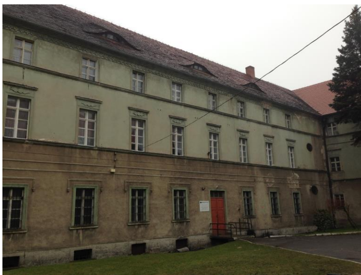
Budynek "B"- do remontu tynki, sztukaterie, stolarka do wymiany, pokrycie dachowe do wymiany, wymiana rur spustowych, rynien, remont instalacji odgromowej, remont wnętrz oraz instalacji wewnętrznej
