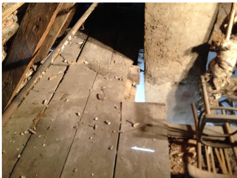
Fot. 18F. Przecięta jętka podczas murowania komina, brak wymianów. Strop strychu w tym obrębie w stanie awaryjnym, do pilnego remontu.
