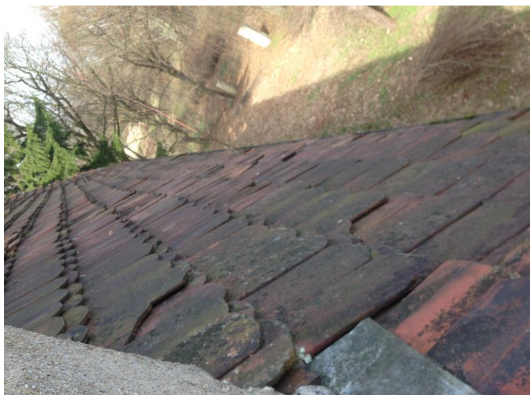
Fot. 10F. Uszkodzone pokrycie dachu.
