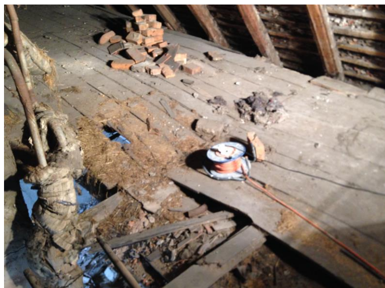
Fot. 20F. Przecięta jętka podczas murowania komina, brak wymianów. Strop strychu w tym obrębie w stanie awaryjnym, częściowo zawalony, do pilnego remontu
