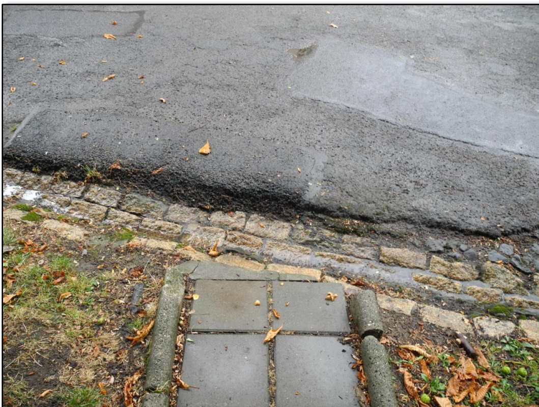
Ryc. 56 Park miejski (zdegradowana infrastruktura drogowa)
