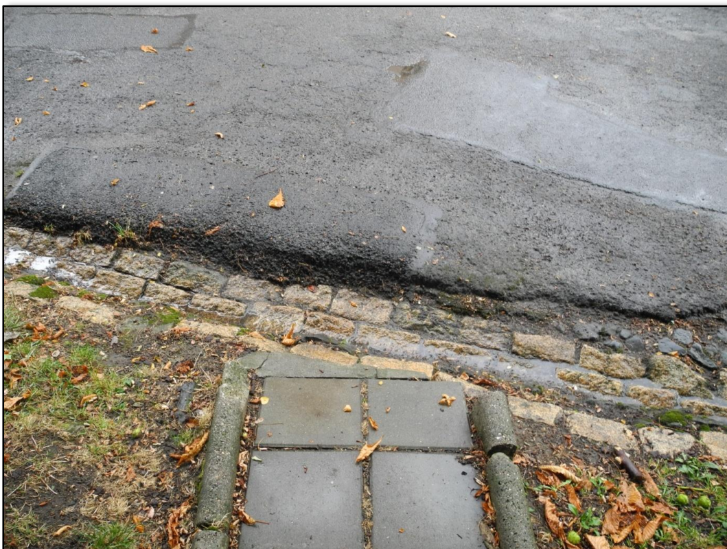
Ryc. 56 Park miejski (zdegradowana infrastruktura drogowa)
