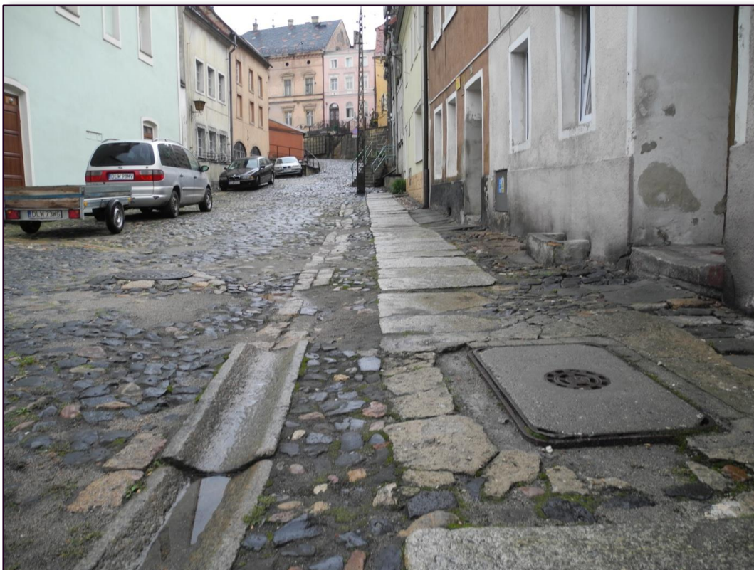
Ryc.28 Zniszczona ul. Kargula i Pawlaka (widok od strony Ratusza)
