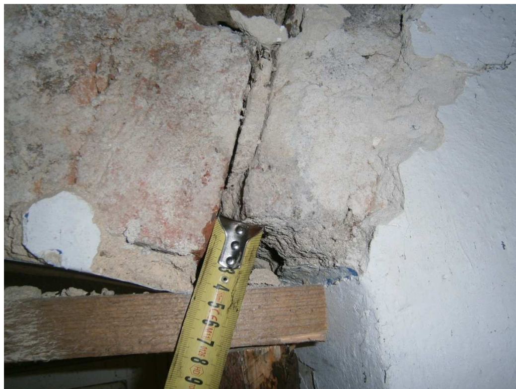
Uszkodzone nadproże okienne ściany szczytowej I piętra
