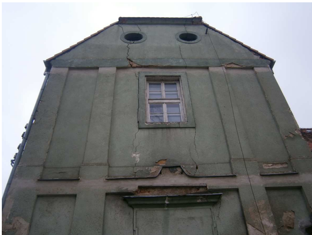
Spękana ściana szczytowa budynku
