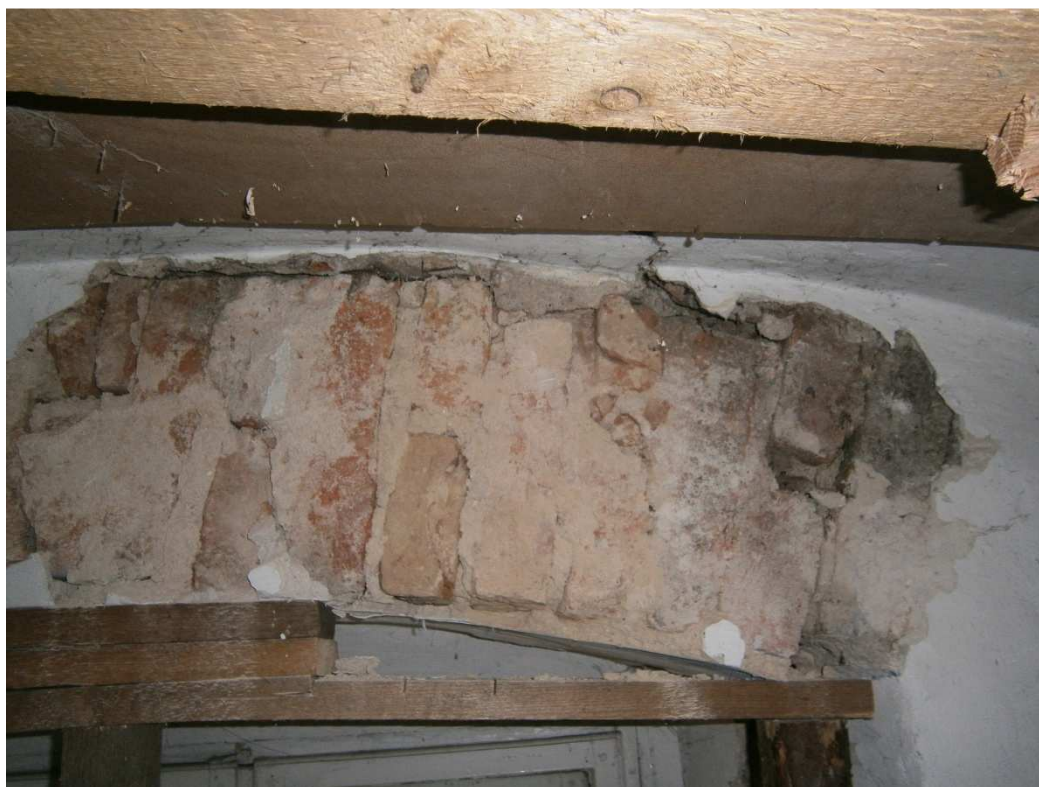
Uszkodzone nadproże okienne ściany szczytowej I piętra
