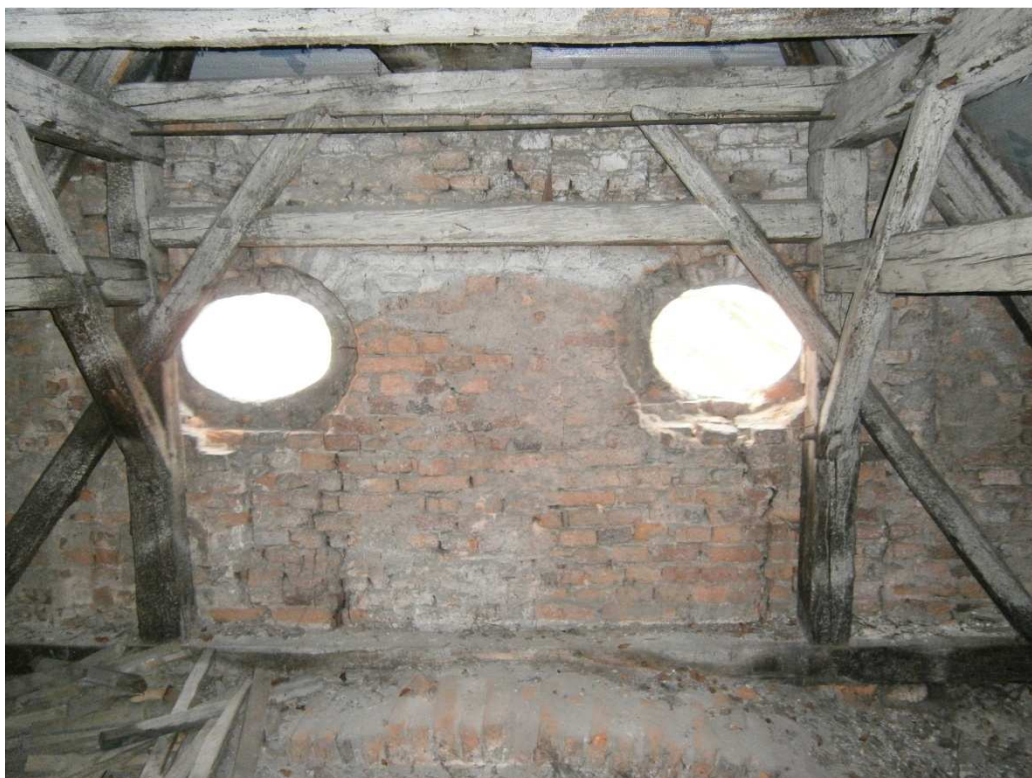
Spękania ściany szczytowej na strychu
