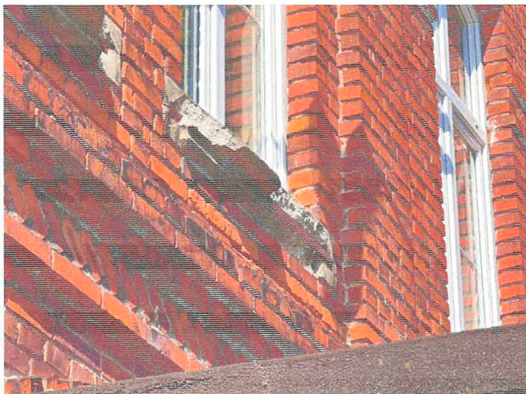
Fot. 33. Budynek plebanii, parapety okienne.
