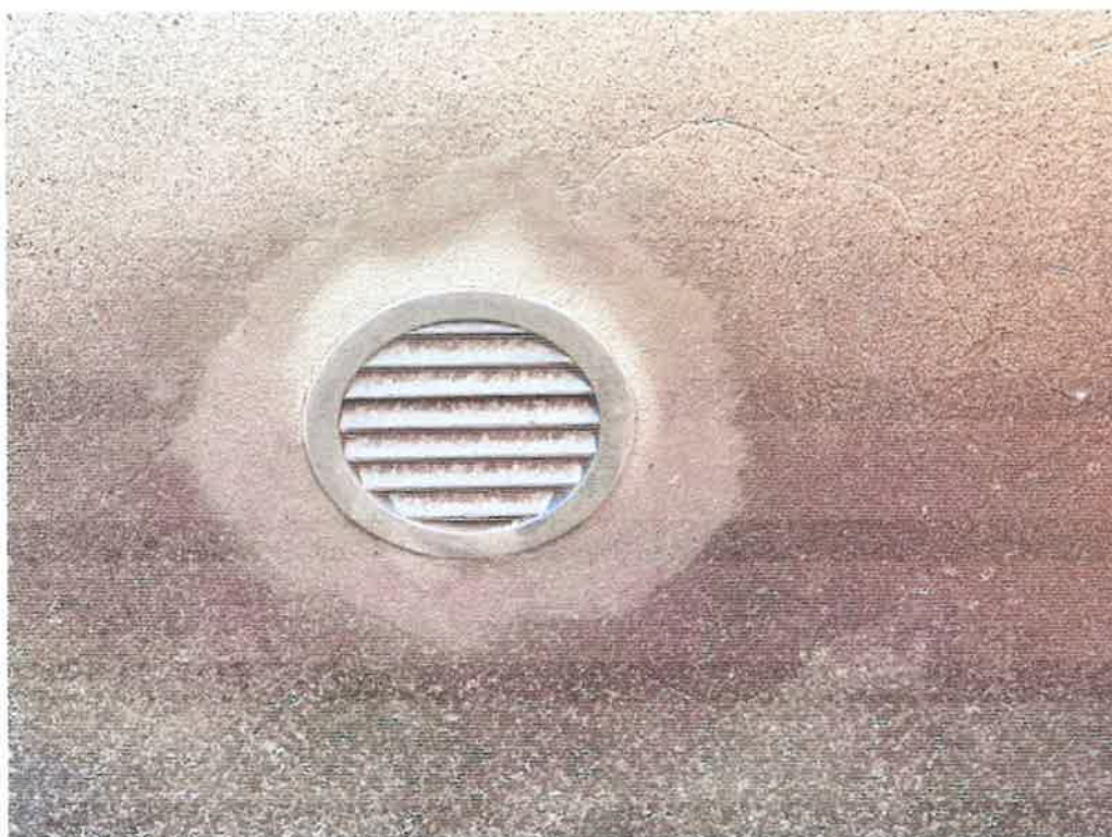
Fot. 19. Budynek plebanii, wentylacja piwnicy.
