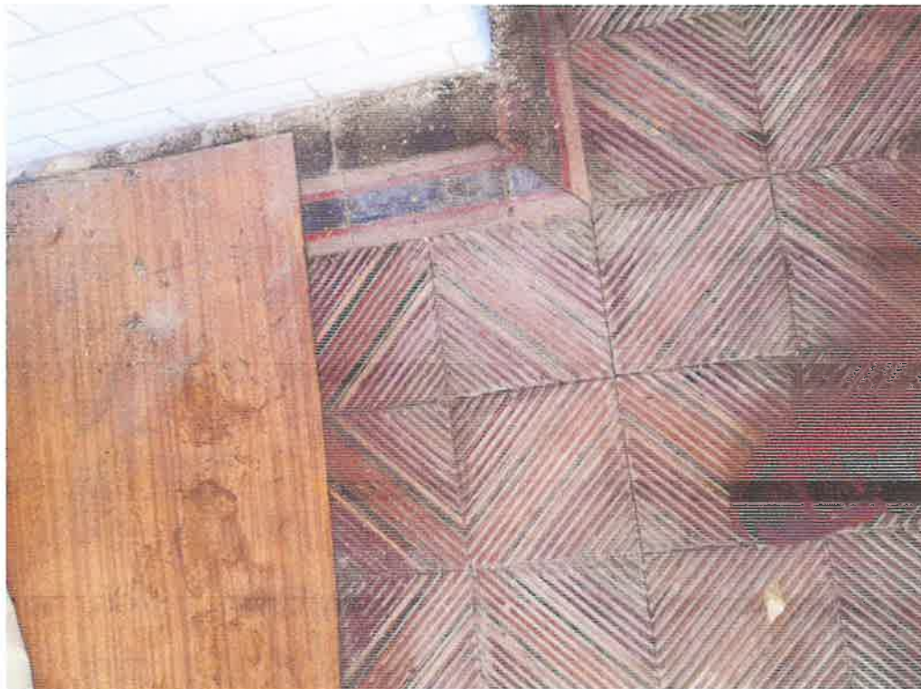
Fot. 23. Budynek plebanii, podłoga w wiatrołapie.
