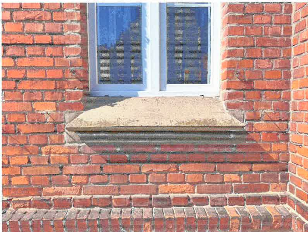
Fot. 32. Budynek plebanii, parapety okienne.
