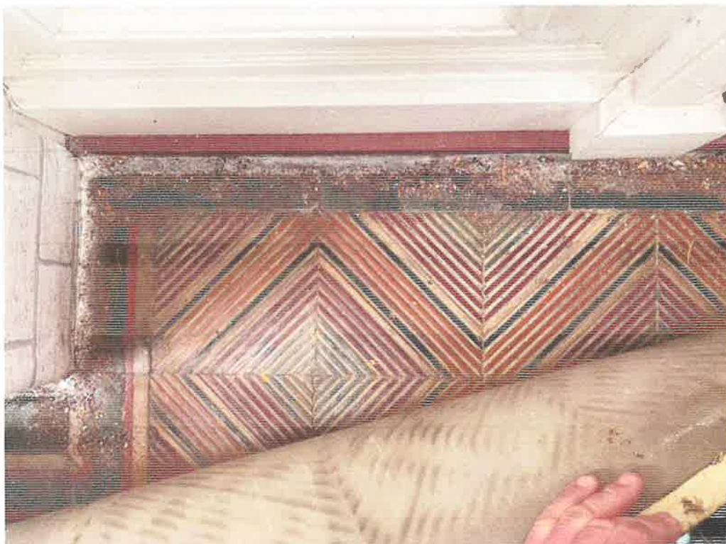
Fot. 21. Budynek plebanii, podłoga w wiatrołapie.
