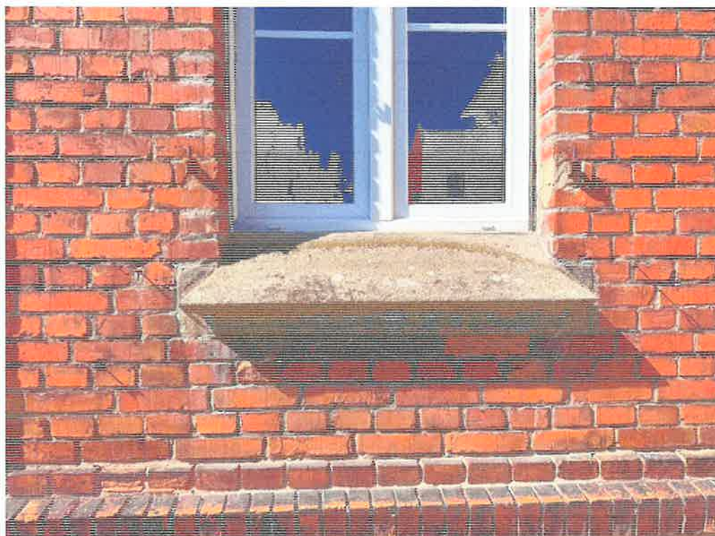
Fot. 31. Budynek plebanii, parapety okienne.
