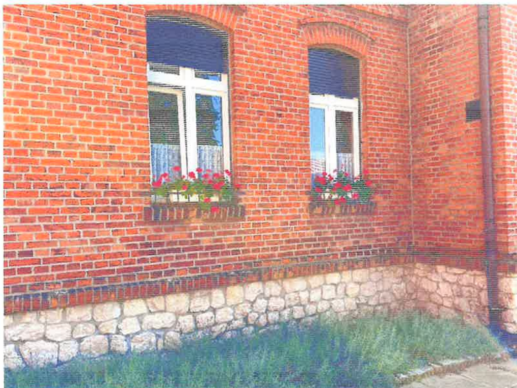
Fot. 35. Budynek plebanii, parapety okienne.
