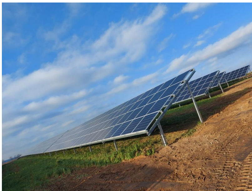
Zdjęcie 4. Przykładowa konstrukcja wsporcza z modułami Źródło: wykonanie własne.
