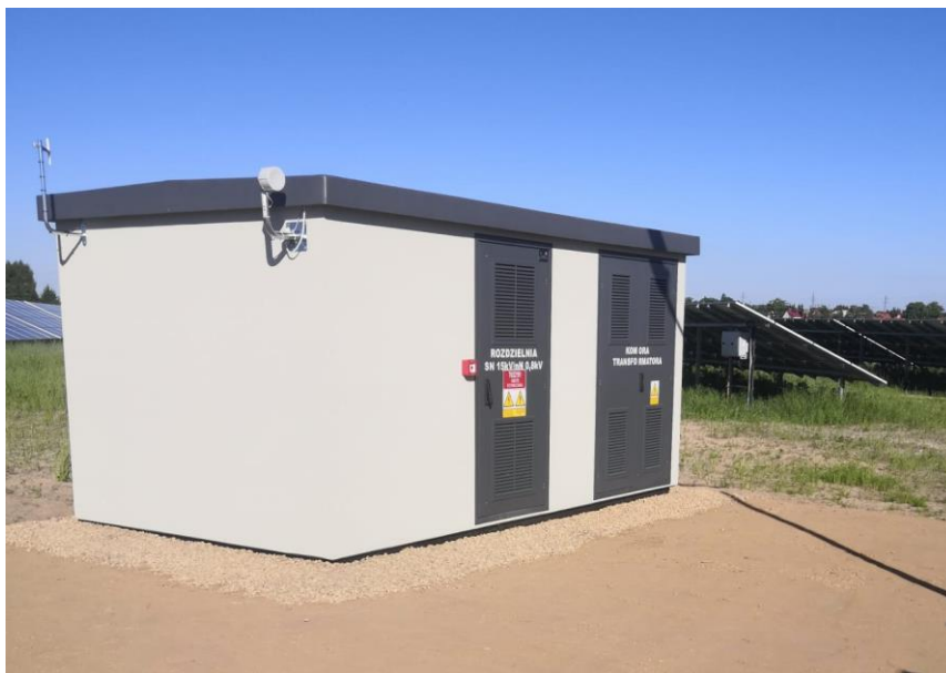
Zdjęcie 6. Przykład kontenerowej stacji transformatorowej Źródło: wykonanie własne.
