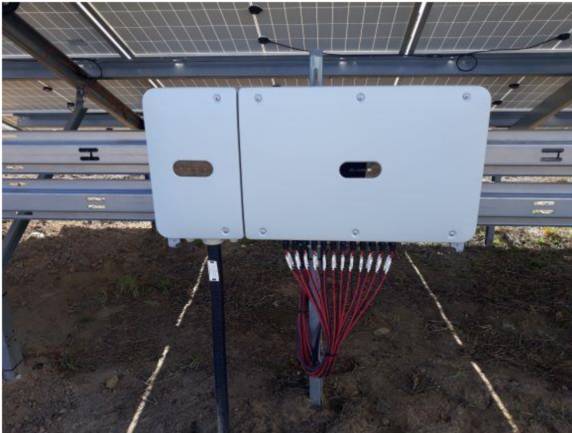
Rycina 7. Przykładowy inwerter farmy fotowoltaicznej.
