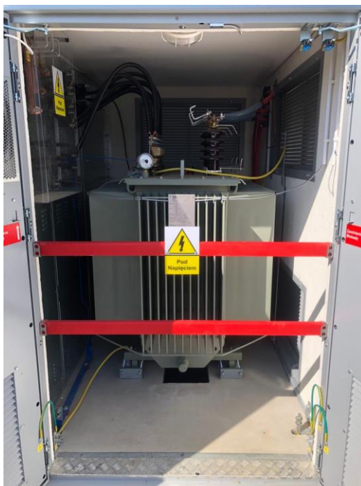
Rysunek 15 Stacja transformatorowa z misą do wycieku oleju (źródło: zdjęcie własne)
