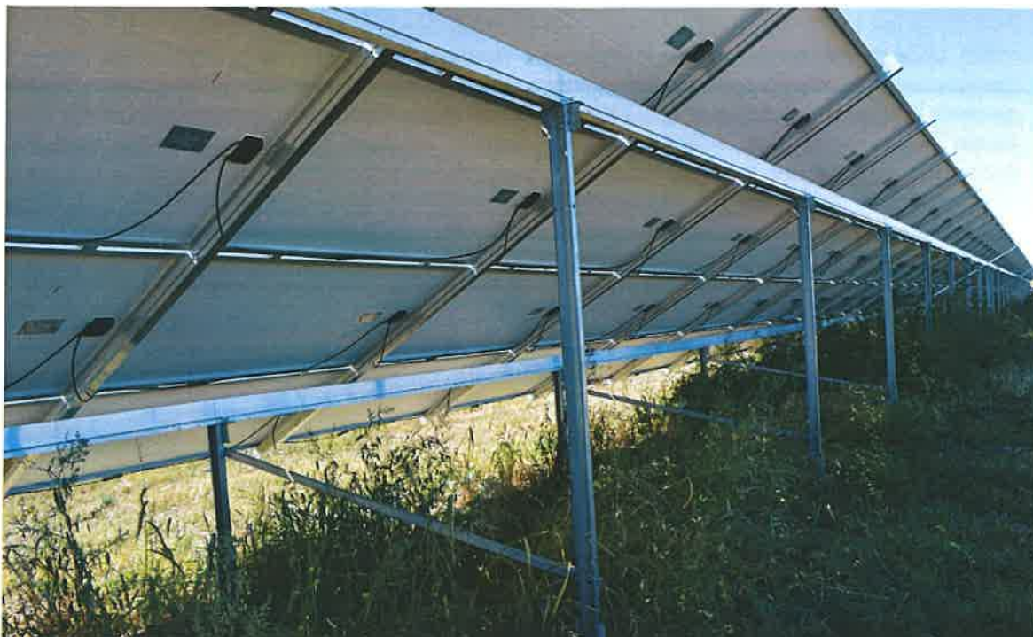
Fot. 3. Widok na przykładowe ukształtowanie podłoża pod panelami, [foto: Paweł Kręciproch, farma fotowoltaiczna Olszanka, woj. opolskie, wrzesień 2019]
