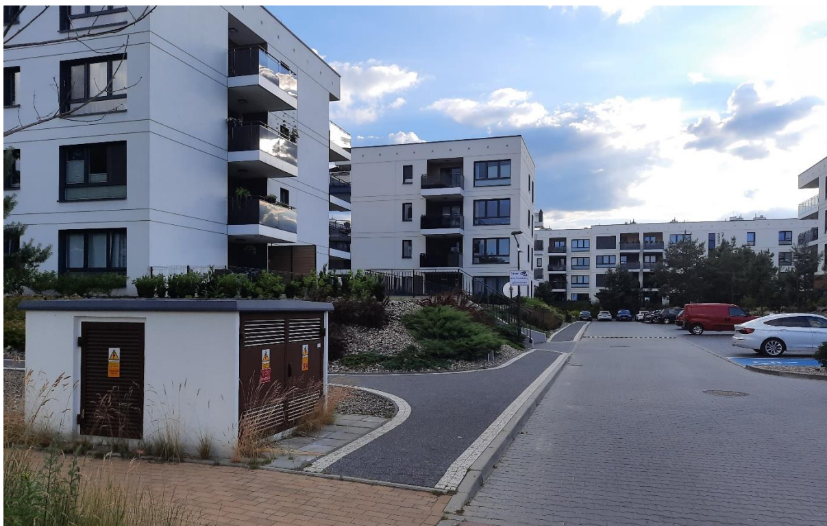
Rycina 10. Standardowa stacja kontenerowa w otoczeniu zabudowy.
