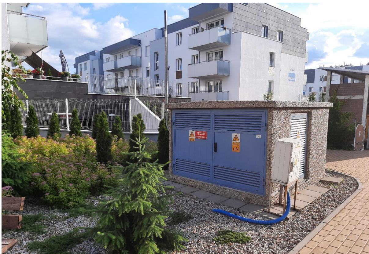
Rycina 11. Stacje transformatorowe w otoczeniu zabudowy mieszkaniowej.
