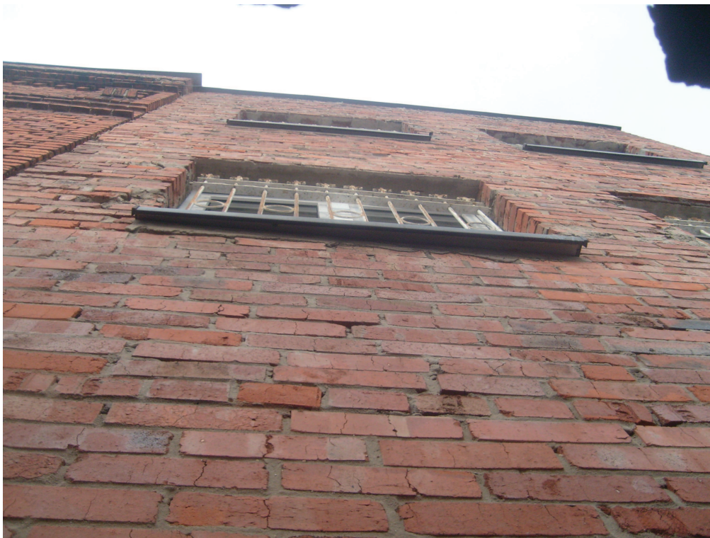
ZDJĘCIE NR 15 – widok od strony południowej, styk ściany budynku pierwotnego i dobudowy, widoczny użyty inny gatunek cegły i typ wiązania
