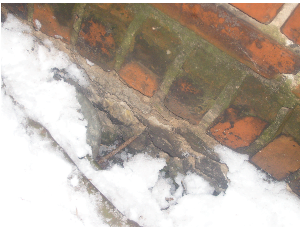
ZDJĘCIE NR 18 – widok od strony południowej, widoczne ubytki cegieł we fragmentach strefy cokołowej fragmenty przemurowane z kamienia polnego
