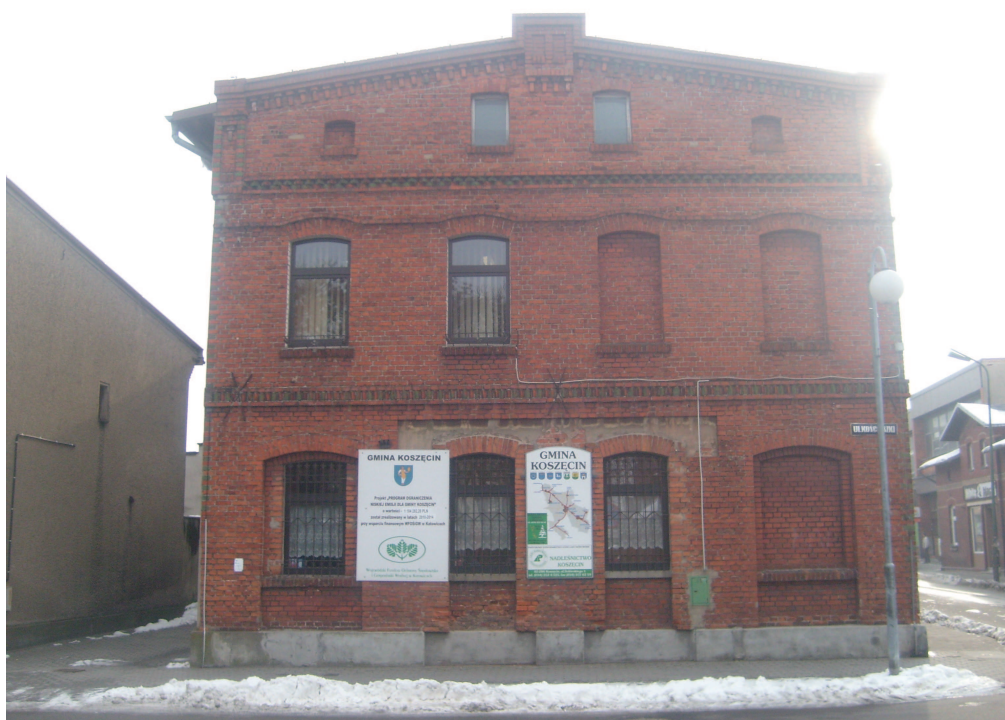
ZDJĘCIE NR 9 – elewacja północna , asymetryczna, widoczne w strefie cokołowej ubytki w/w cokołu a także ubytki cegieł, w ławach podokiennych, dwa parapety betonowe do wymiany na ceglane
