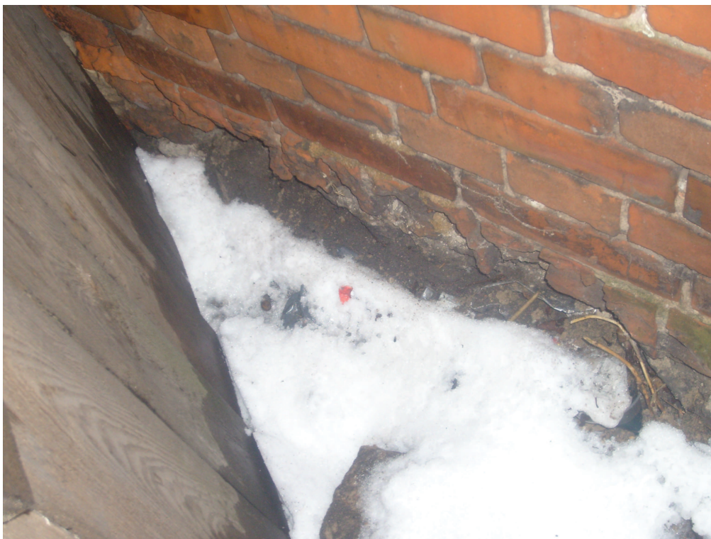
ZDJĘCIE NR 17 – widok od strony południowej, widoczne ubytki cegieł we fragmentach strefy cokołowej
