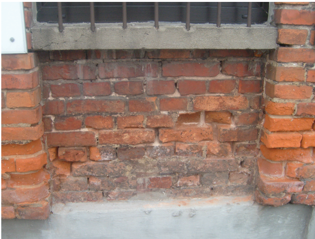
ZDJĘCIE NR 11 – elewacja północna , ława podokienna , najbardziej zniszczony fragment budynku
