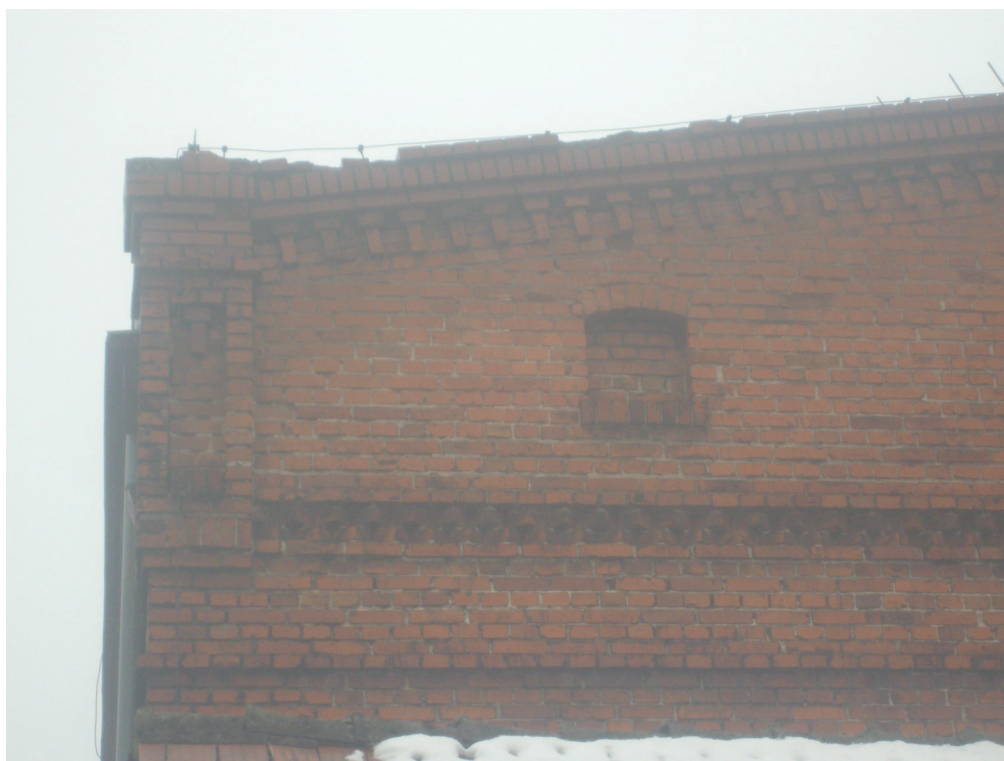
ZDJĘCIE NR 16 – widok od strony południowej, widoczne ubytki cegieł we fragmentach ściany szczytowej
