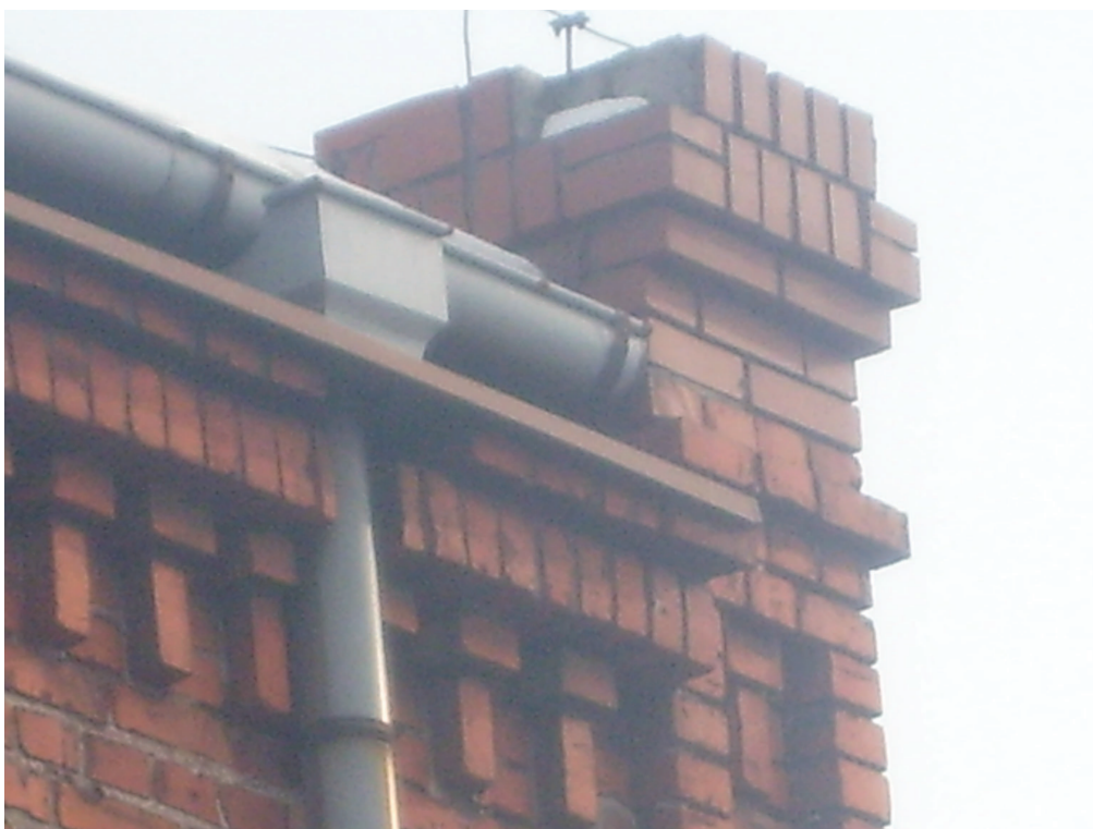
ZDJĘCIE NR 8 – południowo- zachodni narożnik elewacji frontowej, detale górnej części elewacji – pas podrynnowy, widoczne przejście rury spustowej przez gzyms, ubytki cegieł na sterczynach narożnych
