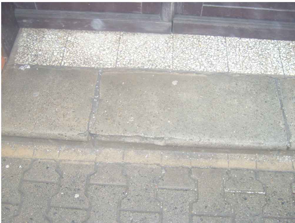
ZDJĘCIE NR 12 – detal, widok z góry na betonową stopnicę, widoczne ubytki i spękania
