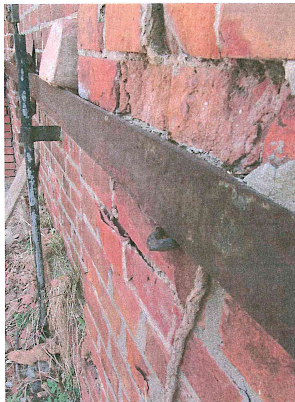
Zbliżenie na dolną część komina od strony zachodniej – rozwarstwienie cegieł.
