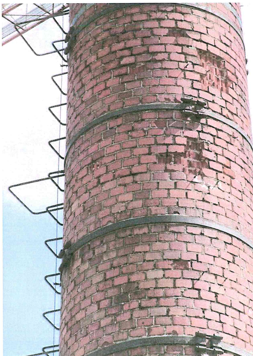
Widoczne ubytki cegieł.
