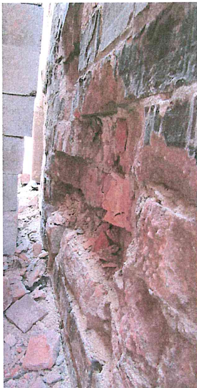
Zbliżenie na uszkodzenia w dolnej części komina od strony północnej.
