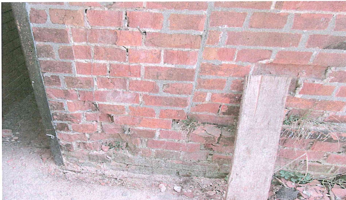
Zbliżenie na dolną część komina od strony zachodniej – zmurzałe cegły.
