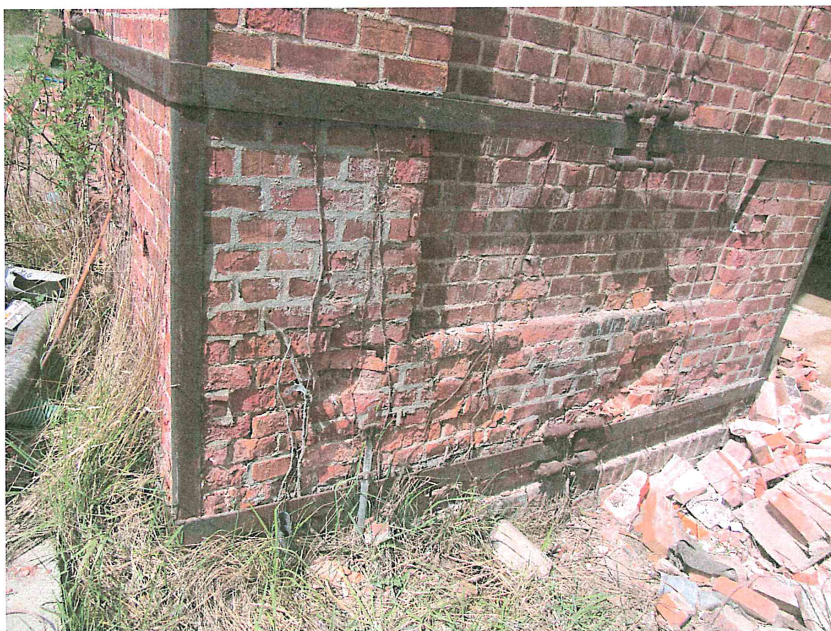
Zbliżenie na dolną część komina od strony wschodniej – zmurszałe cegły.
