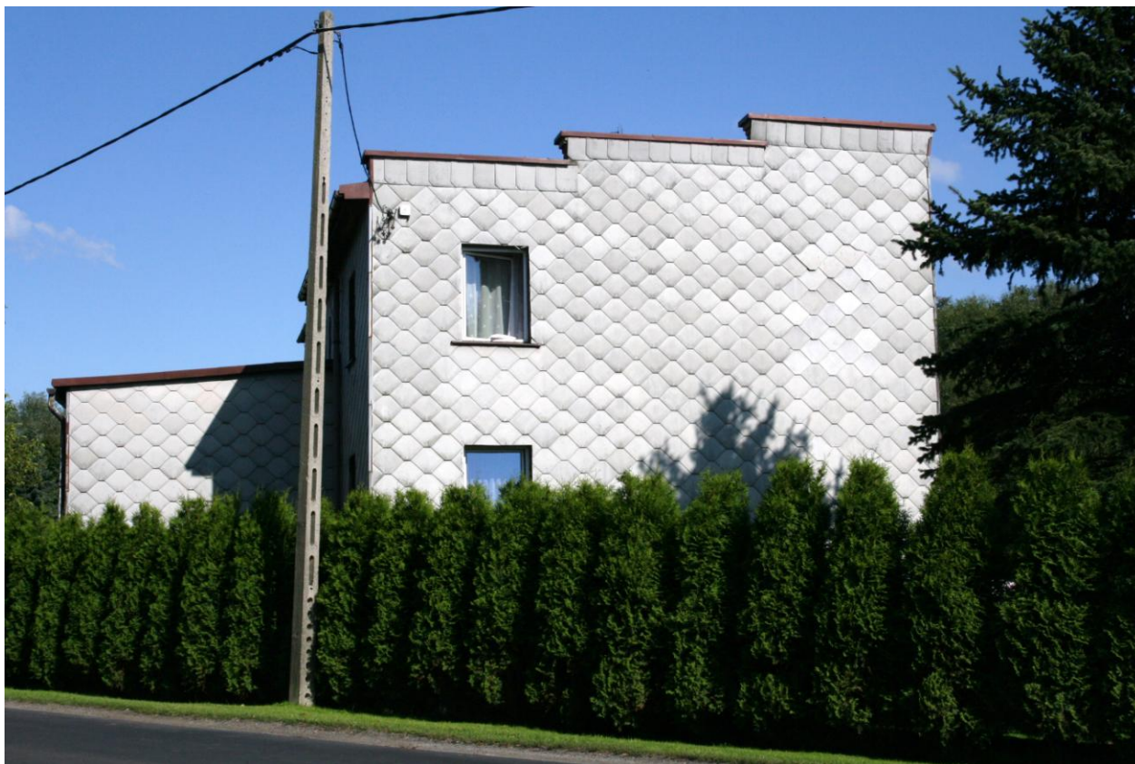
Rysunek 8 Elewacja pokryta płytami azbestowymi płaskimi (III stopień pilności)
