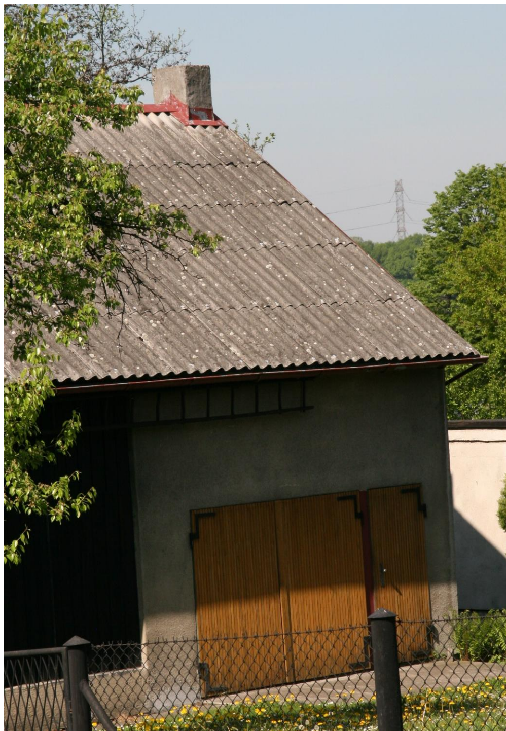
Rysunek 7 Dach pokryty płytami azbestowymi falistymi
