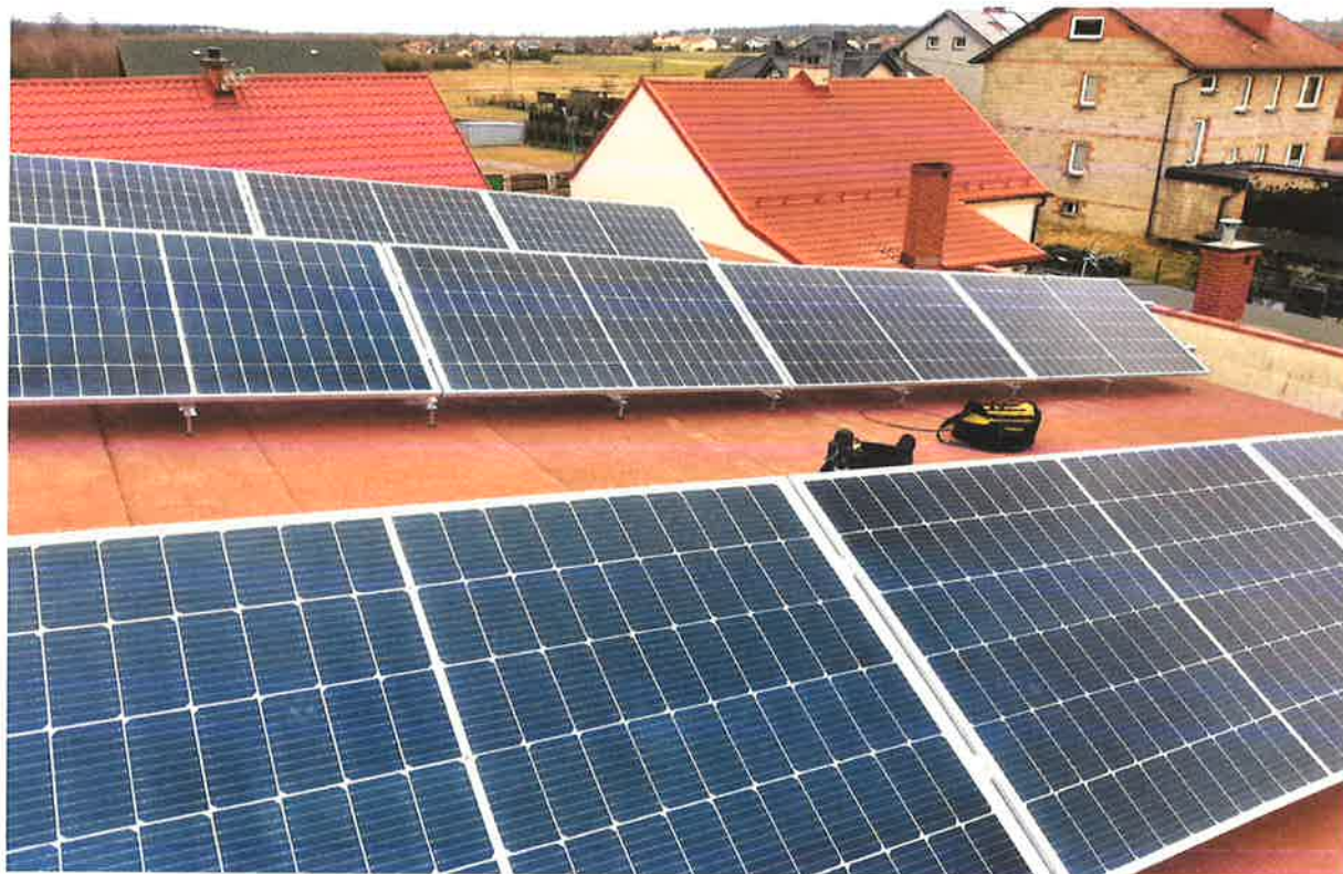
Panele fotowoltaiczne na indywidualnym budynku w Kalinie
