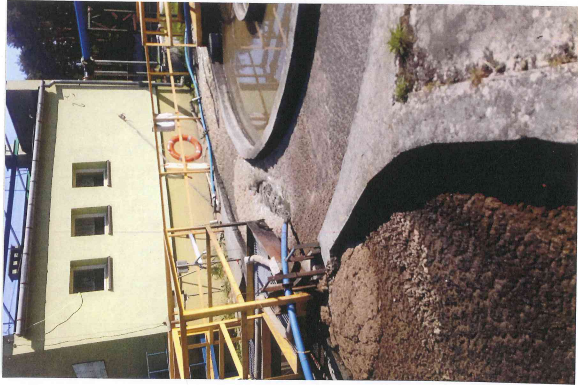
Rys nr 4. Widok złej stabilizacji tlenowej osadu (wypływ osadu - brak tlenu)
