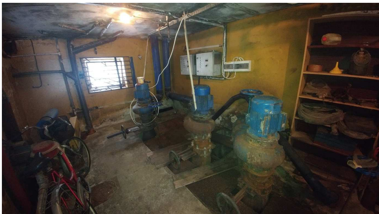
Fot. 4 Budynek pompowni injektorowo-syfonowej (pompy strumieniowe wyłączone z eksploatacji) z jedną czynną pompą recyrkulatu poz. 13 (wg schematu technologicznego) do komory osadu czynnego I stopnia (pompa najbliższej okna)
