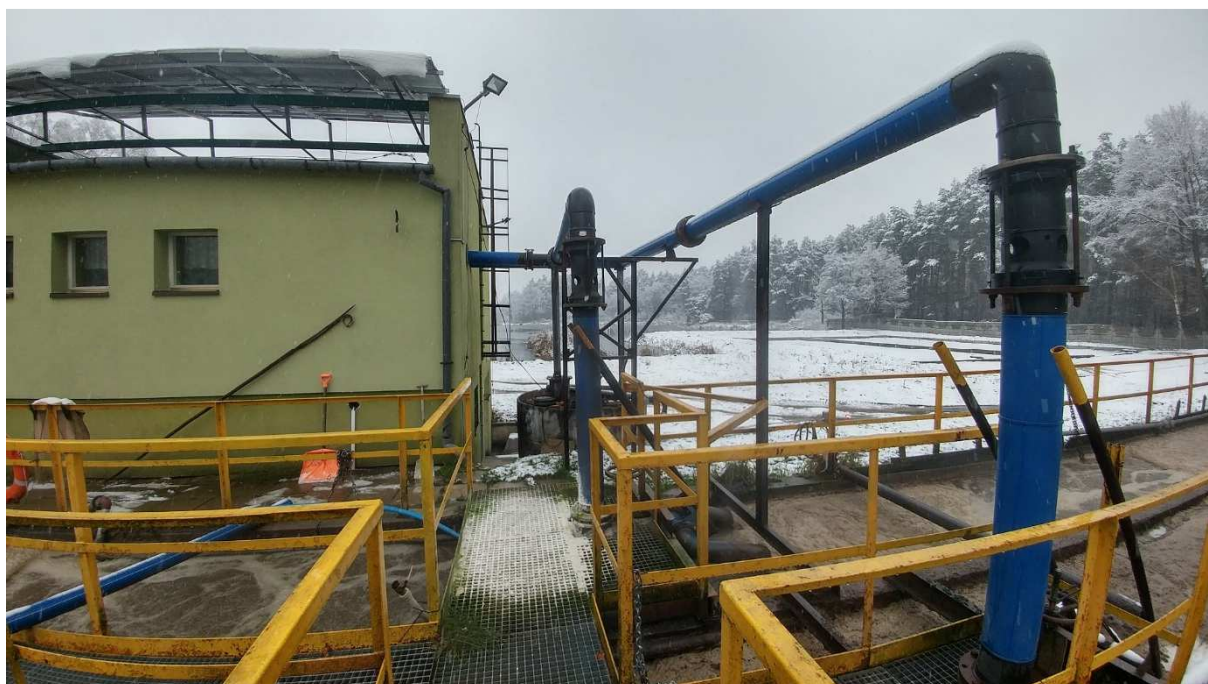
Fot. 5 Rurociągi recyrkulatu na bliższym planie do komory stabilizacji tlenowej - nieczynny (poz.48); w głębi czynny rurociąg tłoczny (poz. 17) do komory osadu czynnego I stopnia (poz.9 wg schematu technologicznego)
