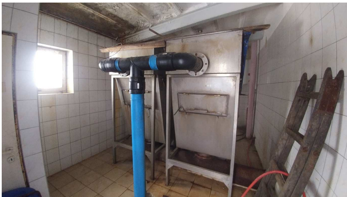
Fot. 3 Doprowadzenie ścieków z przepompowni ścieków surowych (poz.2) na sita łukowe (poz. 4) wg legendy na schemacie technologicznym
