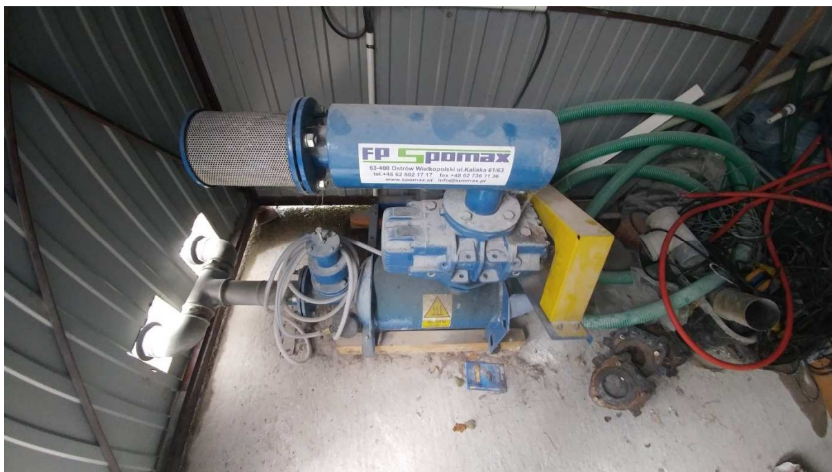
Fot. 6 Dmuchawa z kolektorem sprężonego powietrza (poz.65) w budynku stacji dmuchaw (poz.64)
