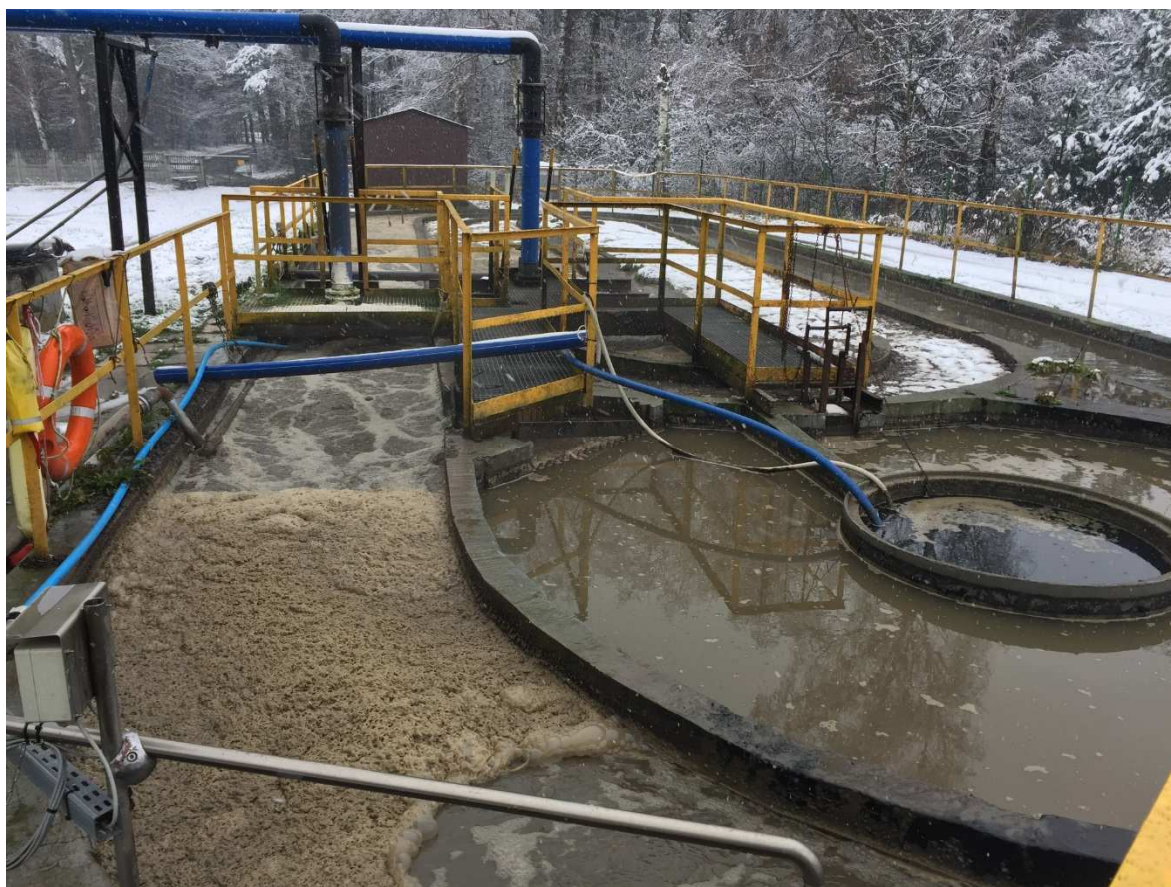
Fot. 8 Komora osadu czynnego I stopnia (część napowietrzna - poz.5), po prawej osadnik stabilizacji tlenowej (poz.8 plan zagospodarowania)
