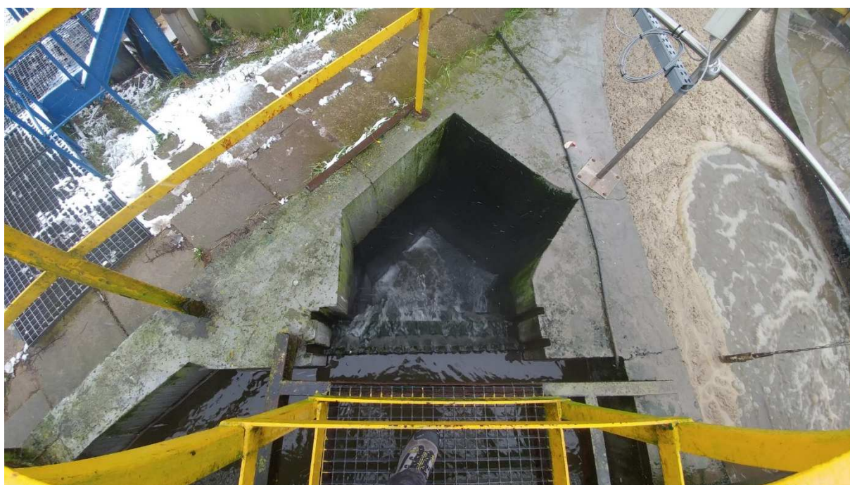
Fot. 13 Odpływ ścieków oczyszczonych z osadnika I stopnia oczyszczania ścieków (poz.6 na planie zagospodarowania)
