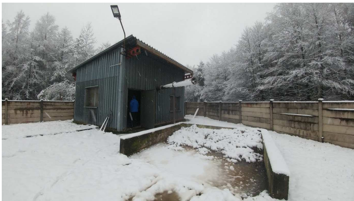
Fot. 4 Plac składowy skratek (poz.2); Budynek krat z rurą podajnika odwodnionych skratek (poz.1)
