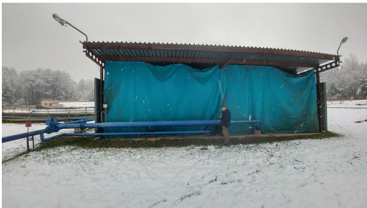
Fot. 9 Widok od czoła wiaty stacji dmuchaw z kolektorami rozprowadzającymi sprężone powietrze (poz. 7)
