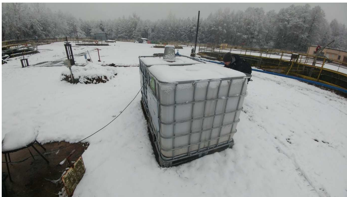
Fot. 8 Stacja dozowania koagulantu - zbiorniki magazynowe(poz.8)
