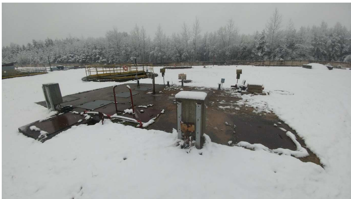
Fot. 12 pompownia ścieków, osadów, recyrkulacji (poz. 14)
