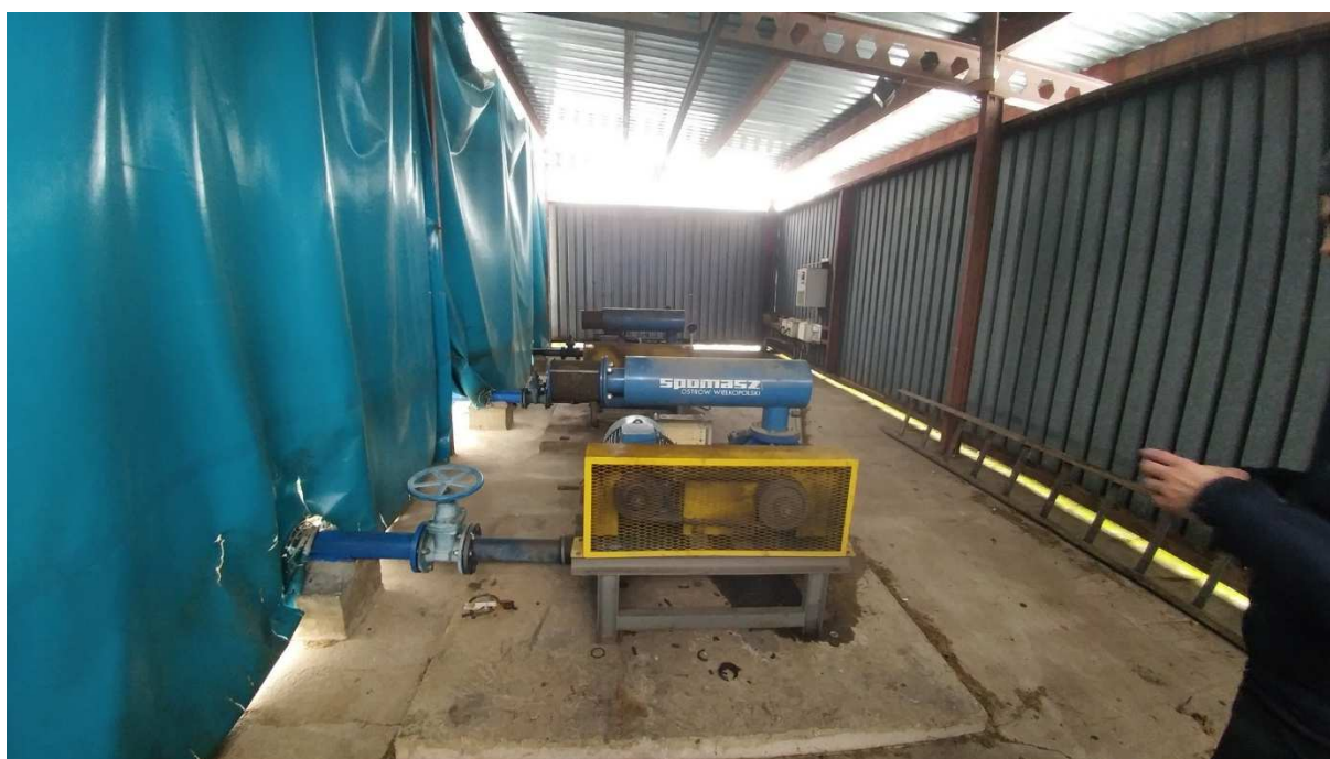
Fot. 10 Wiatra stacji dmuchaw z dmuchawami (poz. 7)
