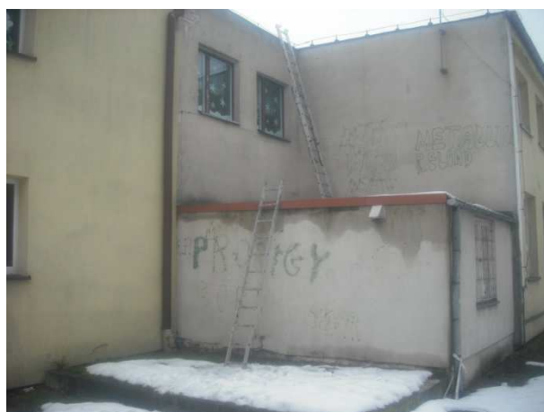
ZDJ. 6 Ściany nieociepłone w rejonie przybudówki szatni
