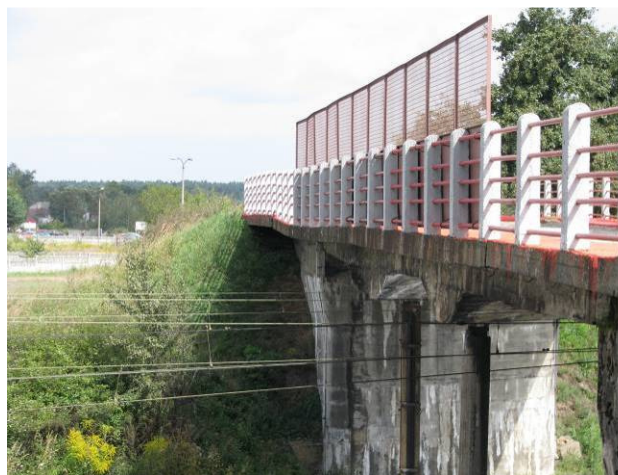
Rys.3.6. Widok z boku. Zauważalna mała odległość sieci trakcyjnej od spodu konstrukcji.
