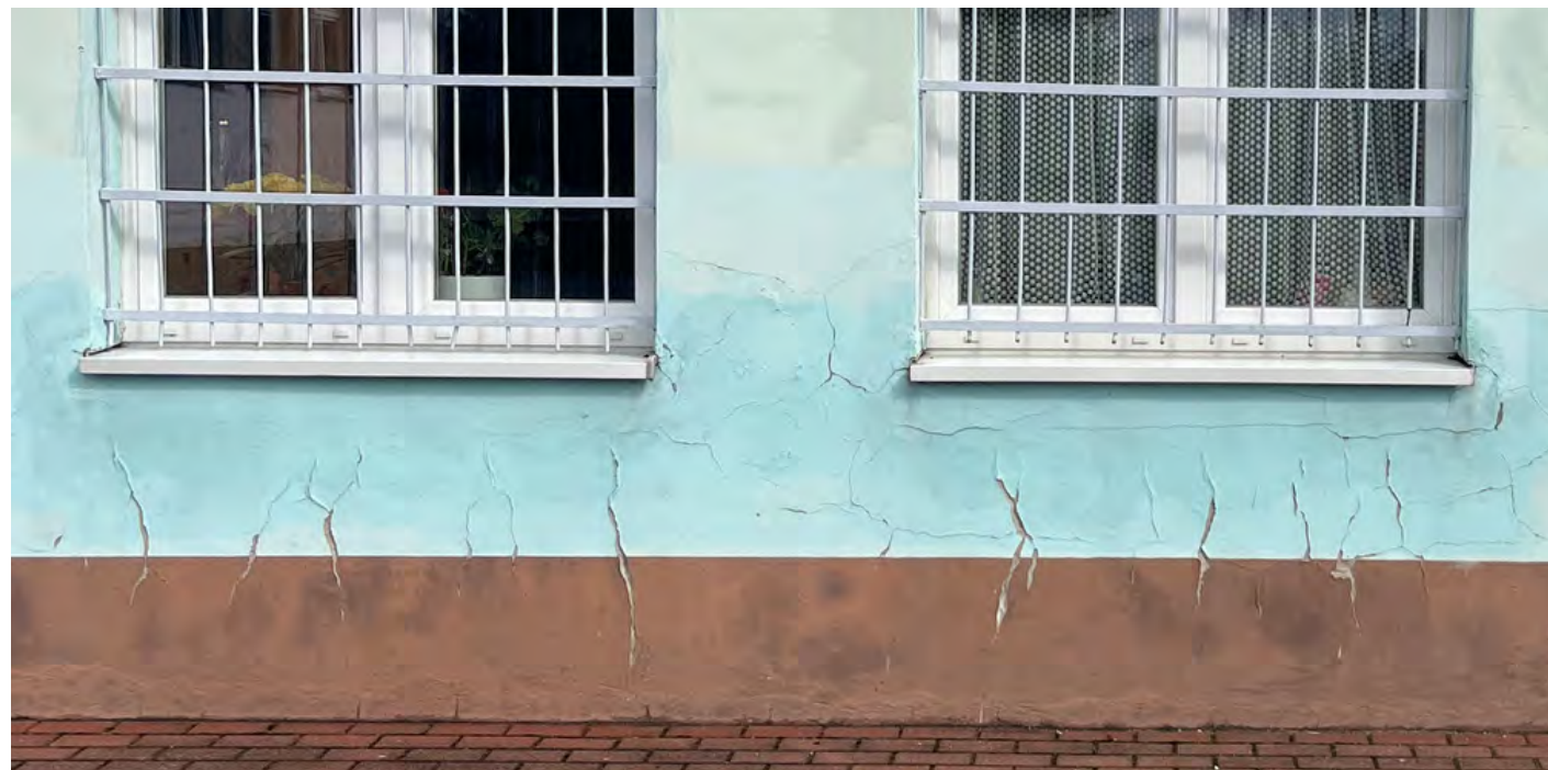
Zawilgocenia ścian, elewacja zachodnia
