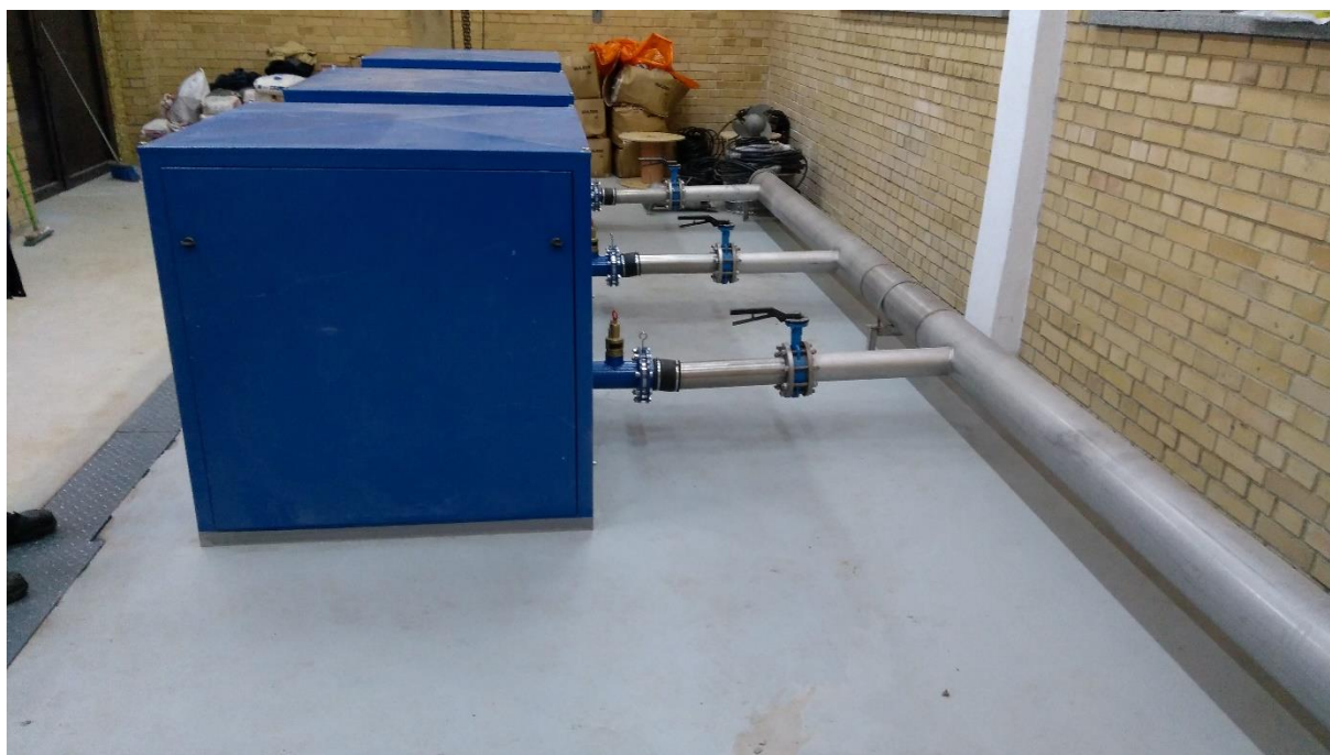
Nowe kompresory w stacji dmuchaw.
