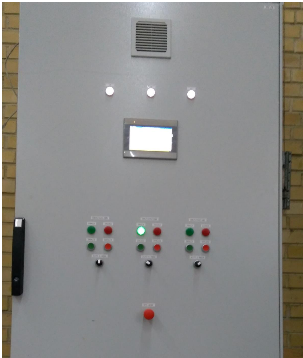
Szafa sterowania automatyką napowietrzania.
