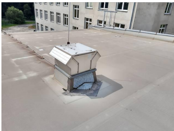
dach hali sportowej – wentylator dachowy
