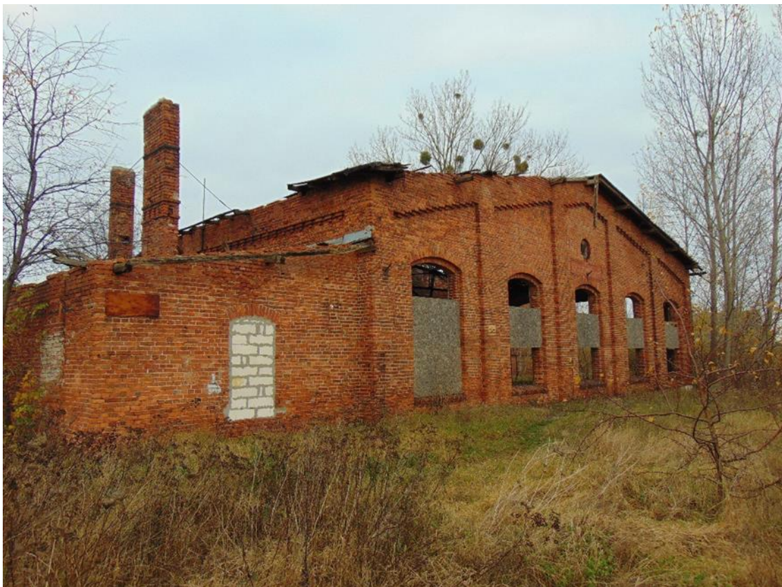
Ryc. 45. Groźący zawaleniem budynek dawnej lokomotywowni w Golańczy, fot. J. Linetty (2023).
