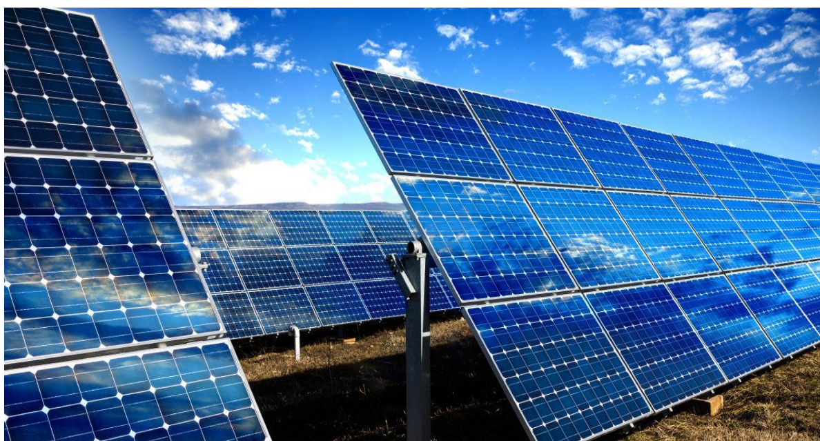
Rys.12 Moduły fotowoltaiczne – trackery o obrocie jednokierunkowym w osi pionowej.
