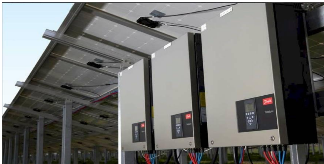
Rys.9 Stelaże z panelami fotowoltaicznymi i inwerterami.
