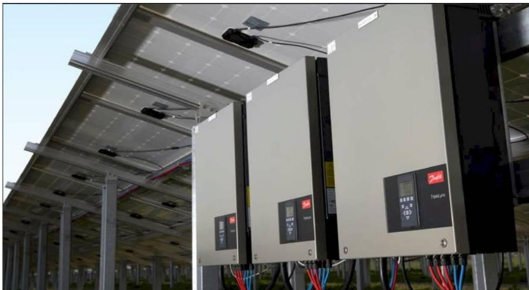
Rys.9 Stelaże z panelami fotowoltaicznymi i inwerterami.
