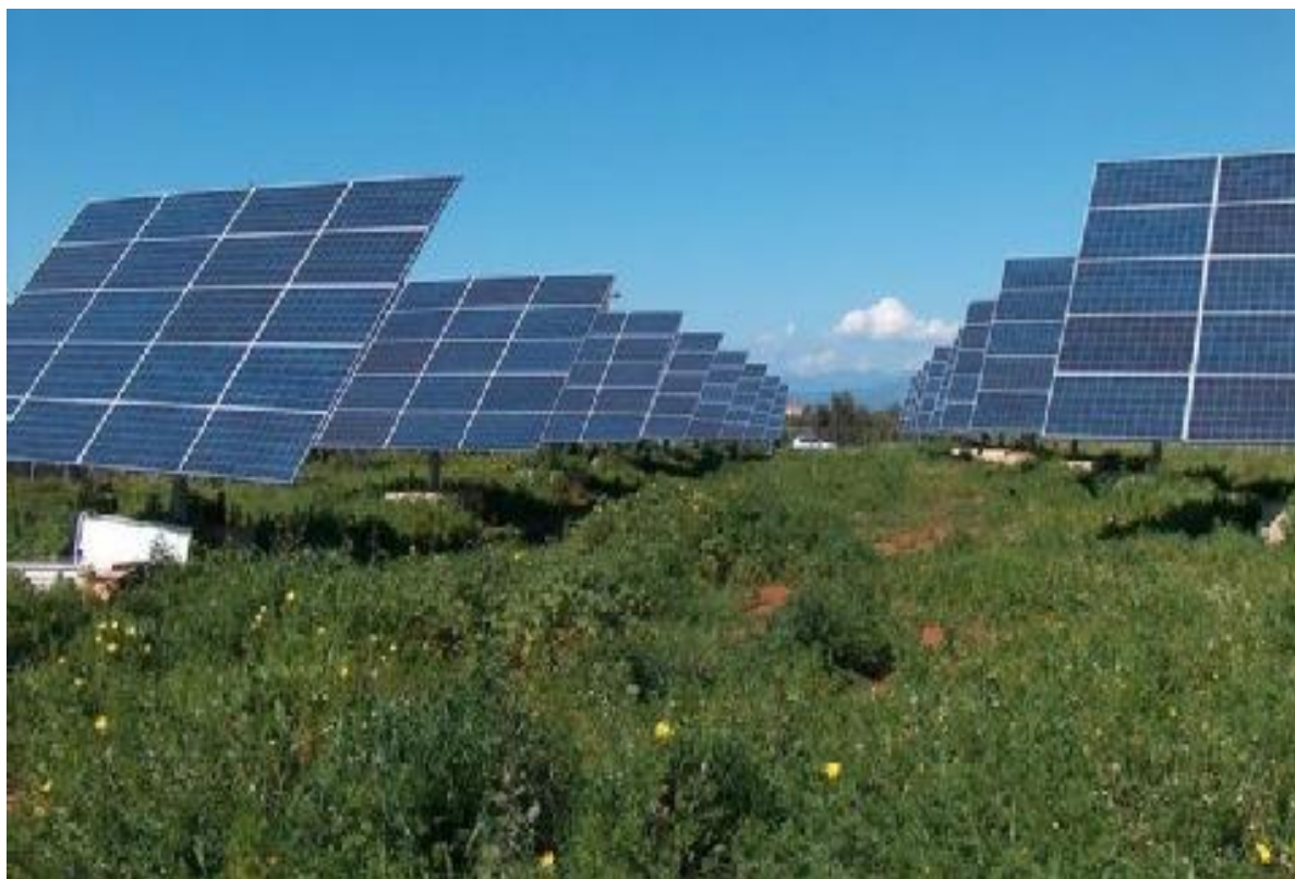
Rys.11 Moduły fotowoltaiczne – trackery o obrocie dwukierunkowym w osi pionowej i poziomej.
