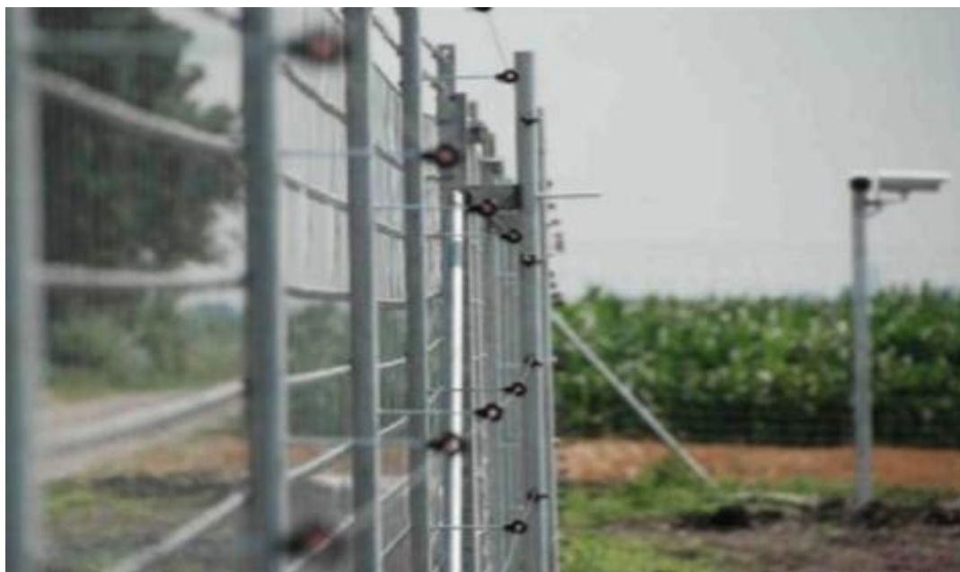
Rys.8 Przykładowe ogrodzenie wraz z systemem alarmowo – monitoringowym
