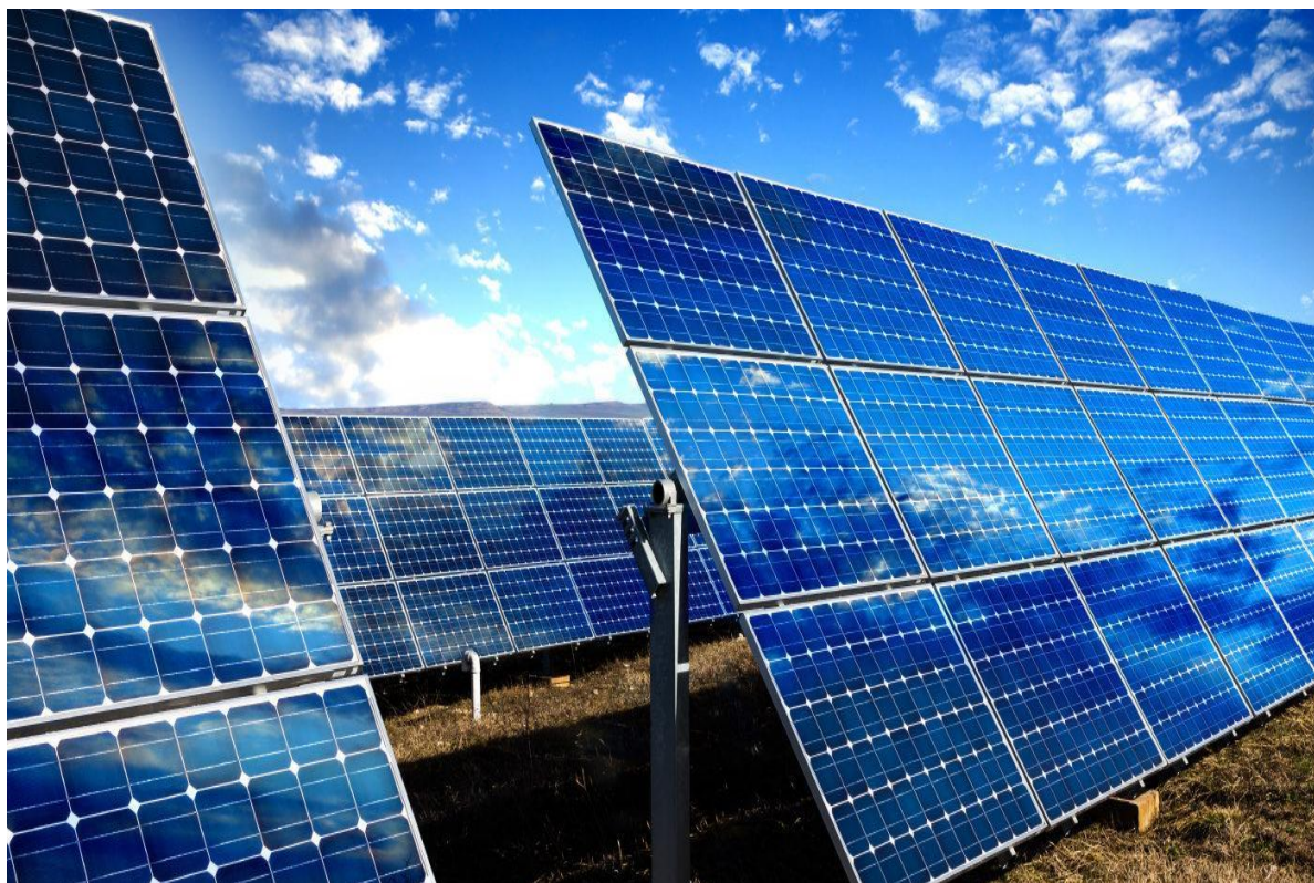
Rys.12 Moduły fotowoltaiczne – trackery o obrocie jednokierunkowym w osi pionowej.
