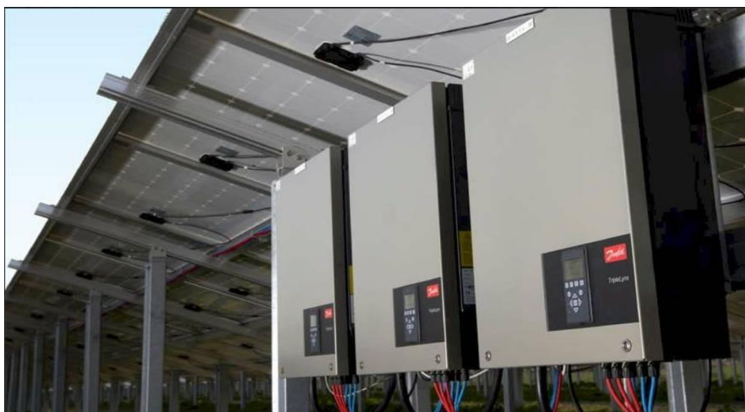
Rys.9 Stelaże z panelami fotowoltaicznymi i inwerterami.
