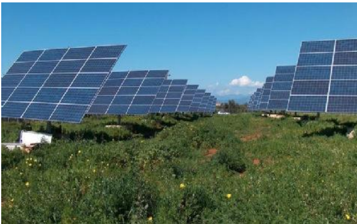
Rys.11 Moduły fotowoltaiczne – trackery o obrocie dwukierunkowym w osi pionowej i poziomej.
