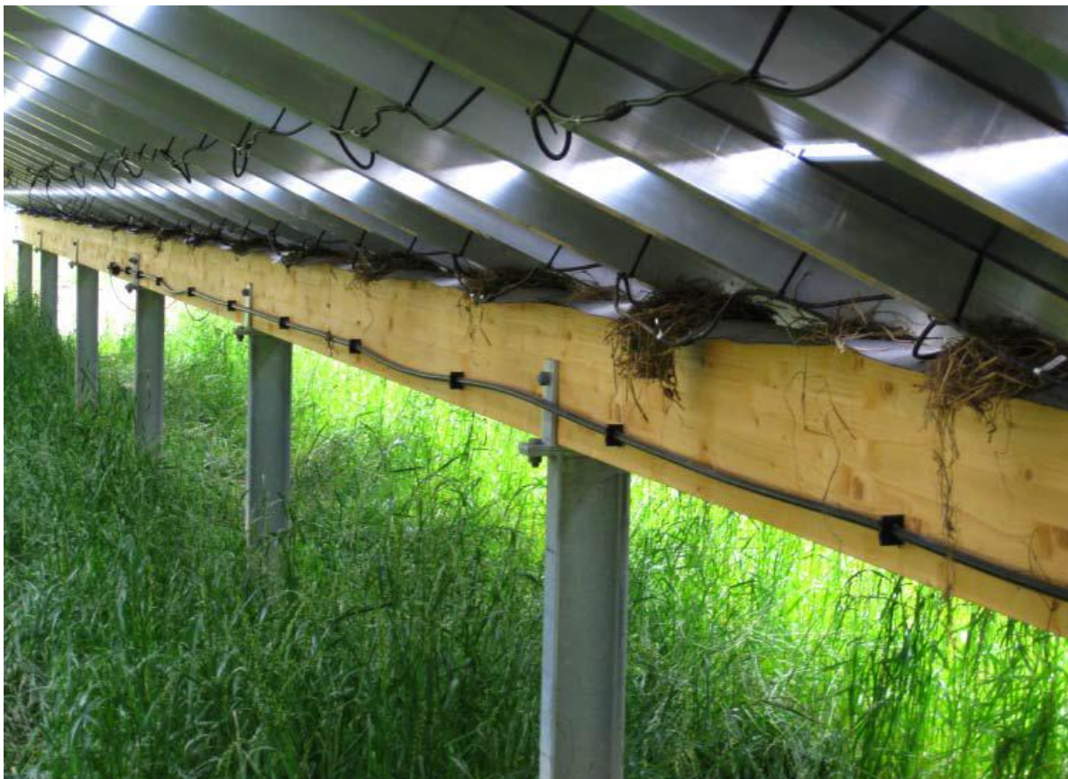
Rys.29 Podpory modułu służą jako miejsca gniazdowania ptaków. Foto: BELECTRIC.
