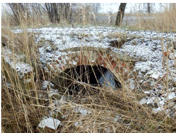
Fot. 44. Uszkodzony przepust w Domaniowie
