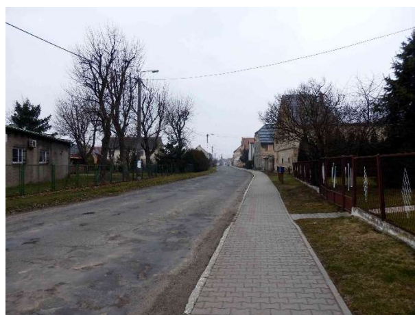
Fot. 28. Droga powiatowa o nawierzchni asfaltowej w złym stanie technicznym, obręb Skrzypnik
