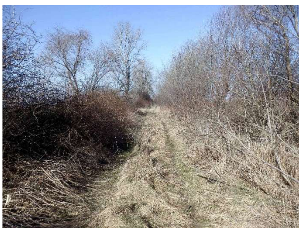
Fot. 23. Droga w złym stanie technicznym, obręb Janków
