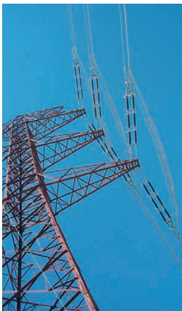
Kratowy słup dwutorowej napowietrznej linii elektroenergetycznej z wiązką trójprzewodową
