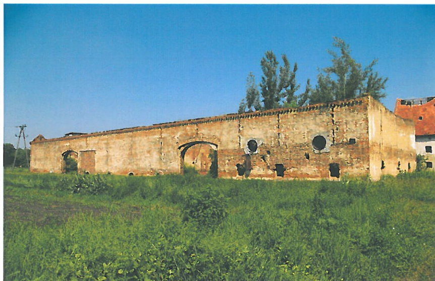
Niszczące zabudowania folwarczne
