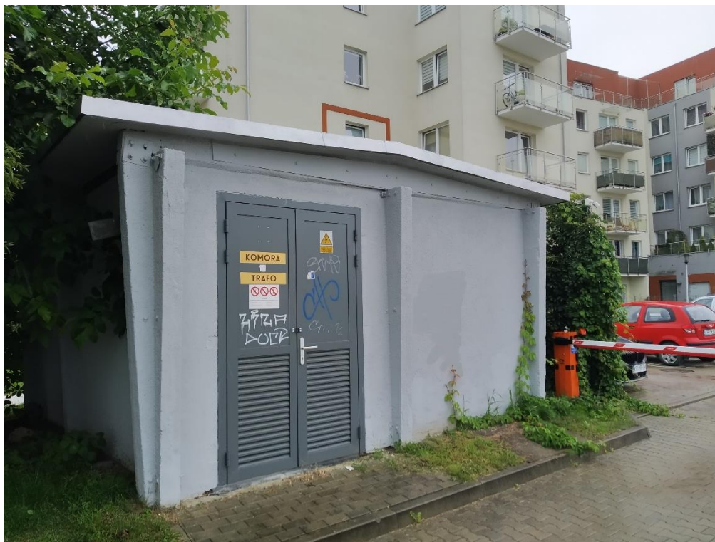
Zdjęcie 4. Stacja elektroenergetyczna nN/SN zlokalizowana w odległości ok. 7 m od budynku mieszkalnego wielorodzinnego (źródło: PGE E.O)
