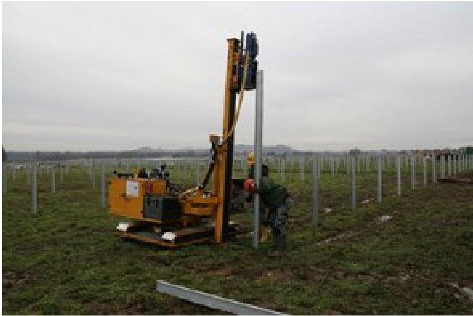
Zdjęcie 2 Montaż profili za pomocą kufara.
