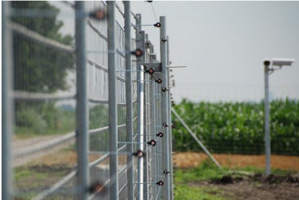
Rysunek 3 Przykładowe ogrodzenie farmy fotowoltaicznej
