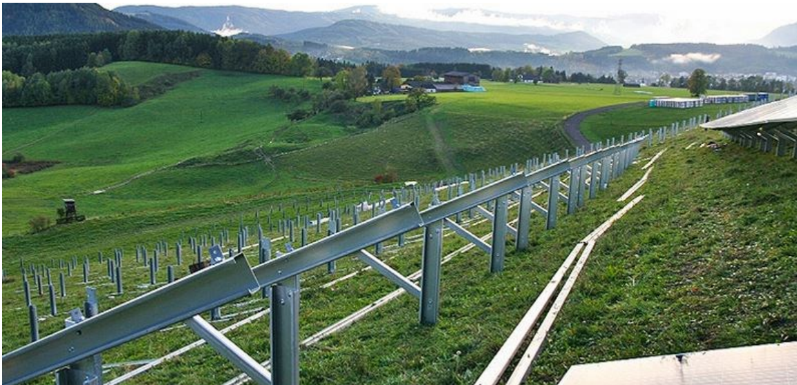
Zdjęcie 3 Konstrukcja przeznaczona do posadowienia paneli fotowoltaicznych.
